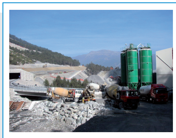
Foto 2 - In primo piano area betonaggio, sullo sfondo galleria in artificiale in fase di realizzazione e zona di frantumazione inerti
