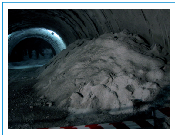
Foto 3 - Fronte di scavo lato valle e cumuli di terreno inertizzati con Spritz-Beton
