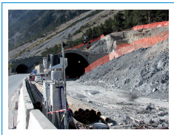
Foto 1 - Stazione monitoraggio polveri e amianto imbocco galleria Cesana lato valle
