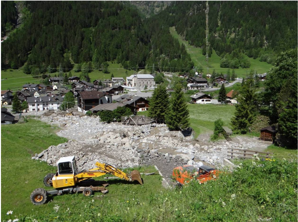
Figura 2. Ramo destro della colata detritica che ha raggiunto le abitazioni poste lungo il tratto regimato del rio Rich. Foto Arpa Piemonte 13/06/2019.
