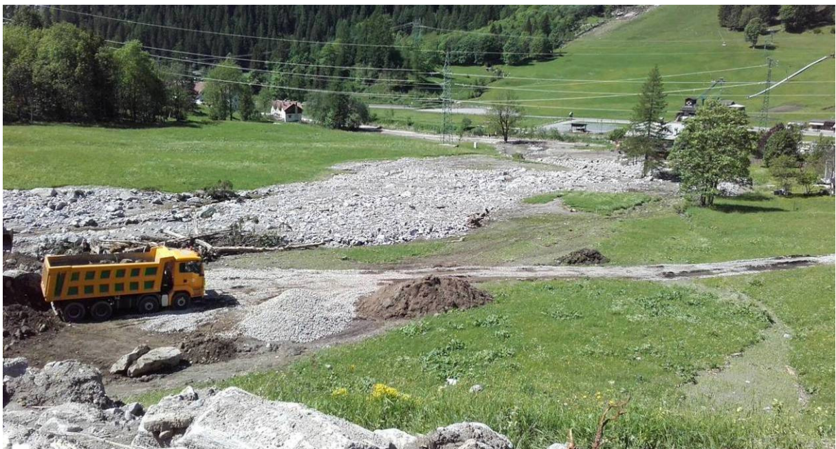
Figura 3. Ramo sinistro della colata detritica. Foto Arpa Piemonte 13/06/2019.
