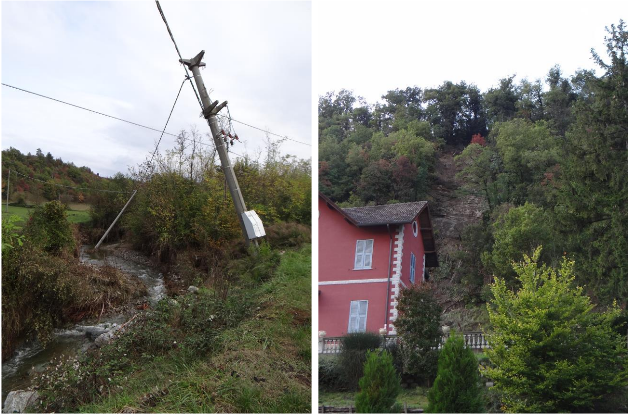
Figura 50. Gavi: danni per erosione di sponda ed esondazione ad opera del torrente Neirone (a sinistra); Serravalle Scrivia: colamento di terra ( earth flow ) sulla provinciale per Gavi (a destra)
