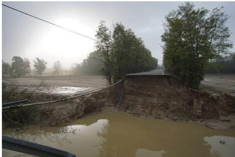
Figura 4. Capriata d'Orba: attraversamento della SP 155 asportato dal Rio Albedosa dove ha perso la vita un automobilista travolto dalla piena (foto Arpa Piemonte)
