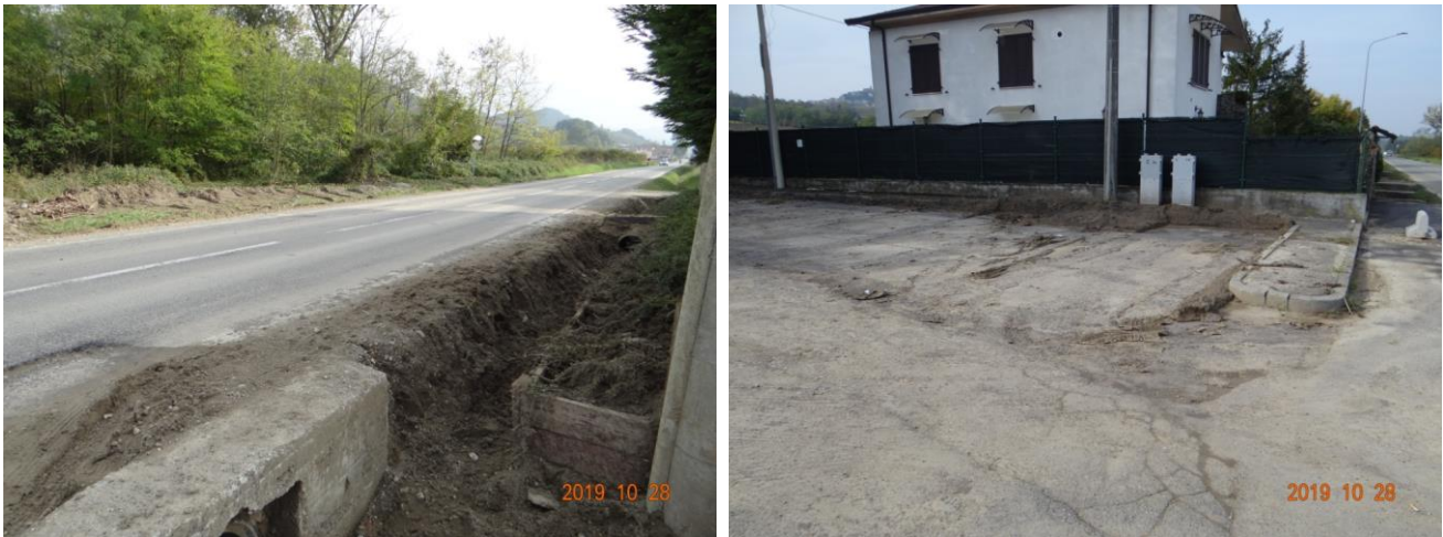
Figura 29. Fossi lungo la SP 120 hanno allagato la sede stradale e parcheggi
