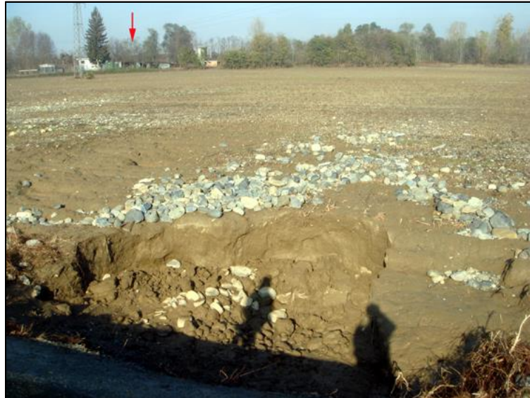
Figura 6. Settore a valle del rilevato della SP 179 dopo il passaggio della piena del 2011. In primo piano gli effetti morfologici causati dalle acque fuoriuscite dai sottopassi idraulici, in secondo piano edifici interessati dalle piene
