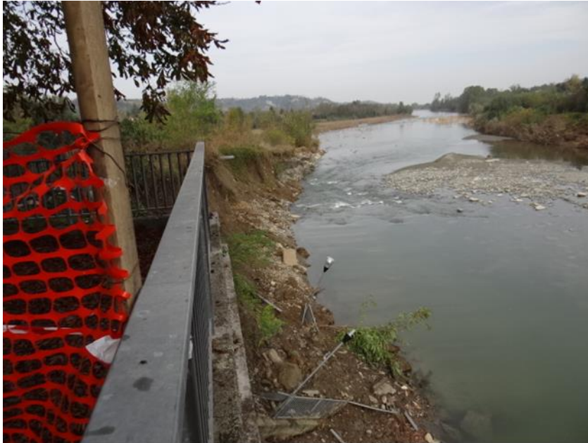
Figura 45. Ovada, Piazza Castello: sponda destra erosa con crollo del muro di sostegno del parapetto del parcheggio
