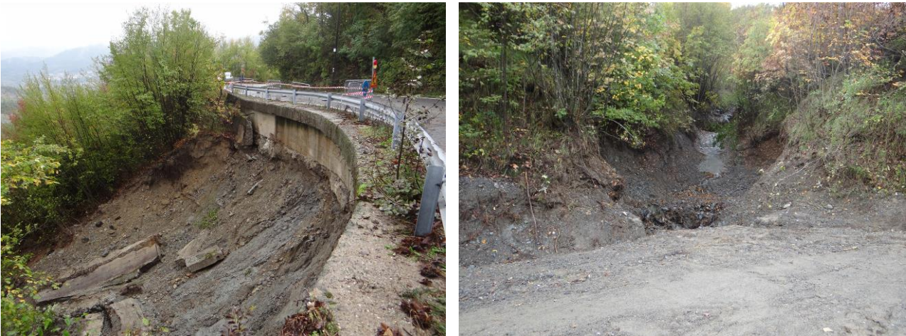
Figura 46. Frane sulla strada comunale tra la valle Scrivia e Carrosio (a sinistra); piena torrentizia nei pressi di borgata Sottovalle (a destra)
