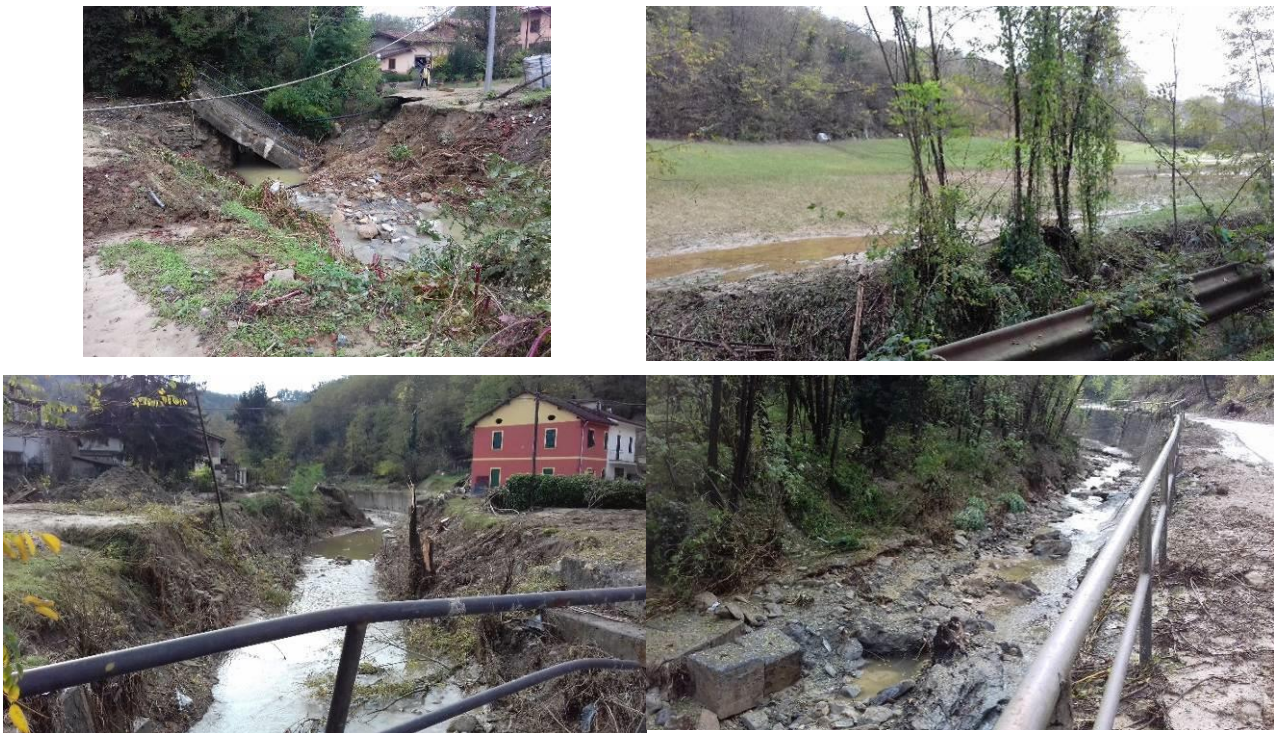
Figura 55. Esempi di danno da erosione di sponda, di fondo, da sovralluvionamento e da rimobilizzazione di corpo di frana in alveo durante piena del rio
