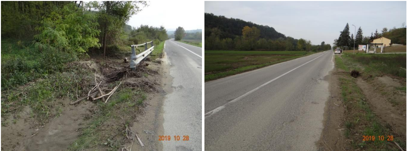
Figura 27. Le acque del rio S. Innocenzo hanno invaso la SP 120 ( a sinistra); l'acqua ha oltrepassato la strada lasciando uno strato di materiale fine e tronchi (a destra)
