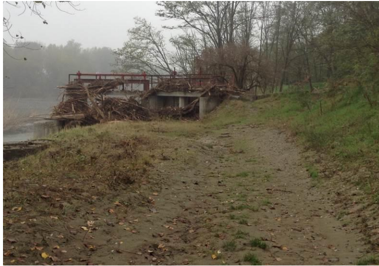
Figura 10. Presa della Roggia S. Michele sormontata dalla piena
