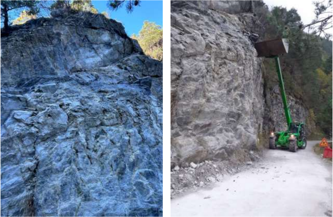
Figura 45 – Macra: crollo in località Albaretto (foto Provincia di Cuneo, Settore Viabilità)
