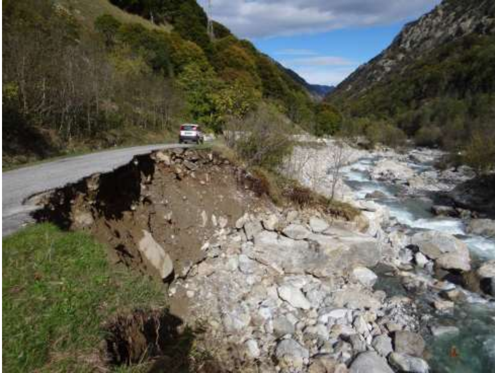
Figura 41 – Entracque: erosione della sponda sinistra lungo il Torrente Gesso della Barra, carreggiata della SP 301 parzialmente asportata
