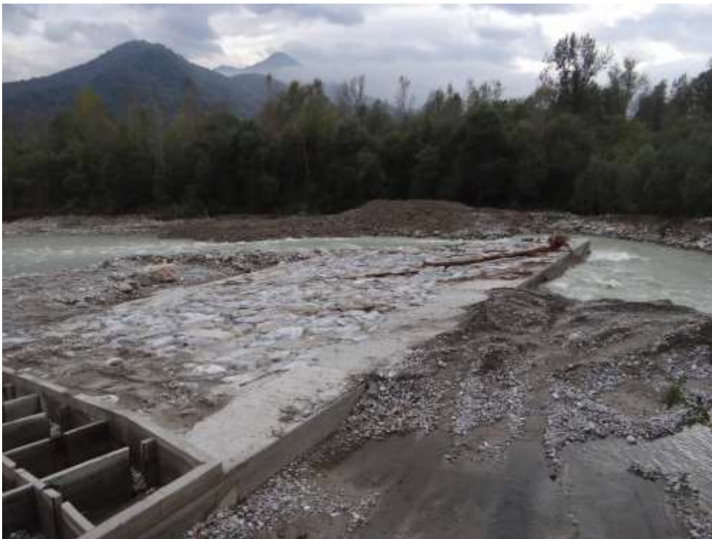
Figura 44 – Borgo San Dalmazzo: traversa di presa sul Torrente Gesso aggirata in destra idrografica
