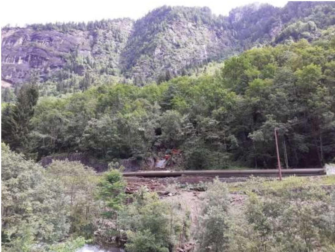
Figura 34 – Panoramica dell'area d'intersezione tra il rio Cugnesco e la strada comunale per l'Alpe Devero effetti del passaggio della colata sopra alla condotta forzata e del materiale depositato sulla sede stradale
