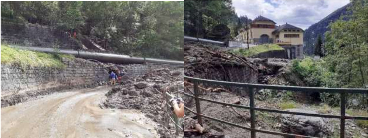
Figura 35 – Particolare dei materiali che sono stati trasportati dal trasporto di massa: nella foto a sinistra il materiale fine ha raggiunto il ponte sul T. Devero, nella foto a destra il materiale più grossolano presente sulla sede stradale
