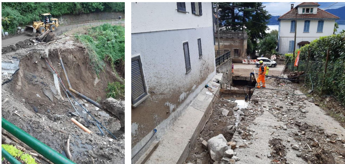
Figura 27: danni alla strada e sottoservizi (a sinistra), ostruzione dell'alveo del rio ( a destra)
