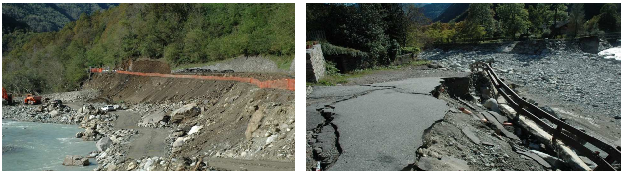
Figura 59 - Cravagliana, asportazione della SP 9 all'altezza di Cravagliana – Piano delle Fate (a sinistra); Campertogno, erosione di sponda ad opera del Sesia con danni alla via di collegamento al campeggio e asportazione completa della passerella sul torrente (a destra).
