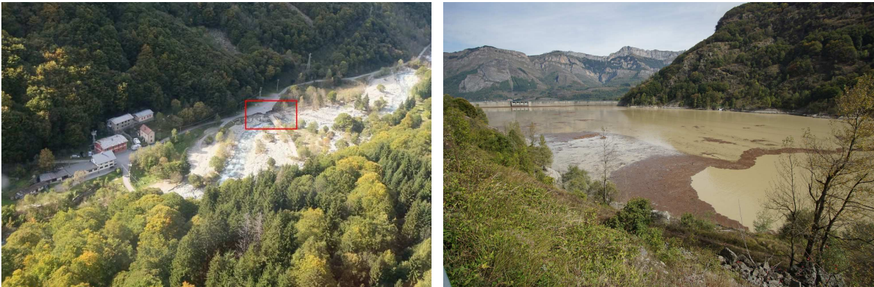
Figura 93 - Entracque: abitato di San Giacomo di Entracque ripreso da elicottero; nel riquadro rosso il ponte per il Vallone di Monte Colombo danneggiato per erosione spondale (a sinistra); materiale fluitato nell'invaso della diga della Piastra (a destra).
