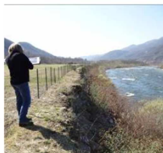
Sponda erosa in corrispondenza dell'avioaeroporto di Roccapietra, vista da monte (2014).
