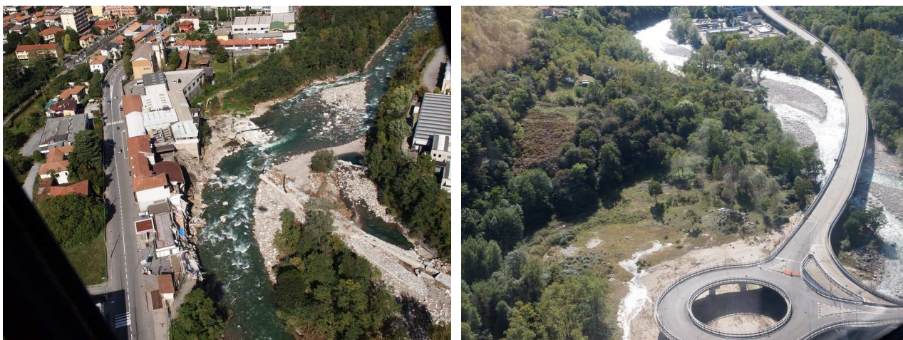
Figura 54 - Omegna, alcuni processi erosivi del T. Strona hanno interessato le strutture portanti di alcuni edifici artigianali (a sinistra) e il pilone della tangenziale (a destra)
