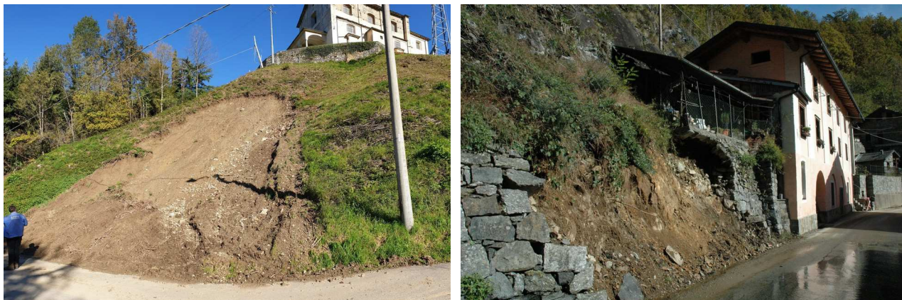
Figura 64 - Frana scarpata di controripa in località Camasco, Varallo (a sinistra) e località Molino, Cravagliana (a destra).
