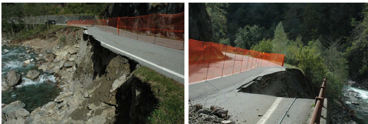
Figura 60 - Danni alla viabilità per erosioni di sponda, lungo la SP 9 tra Cravagliana e Fobello.
