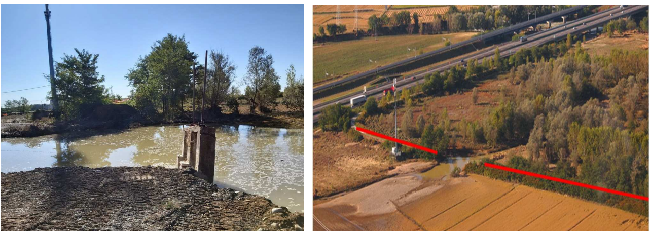
Figura 80 -Particolare della rottura arginale (a sinistra); vista da elicottero della rottura arginale e della vicina autostrada (a destra).
