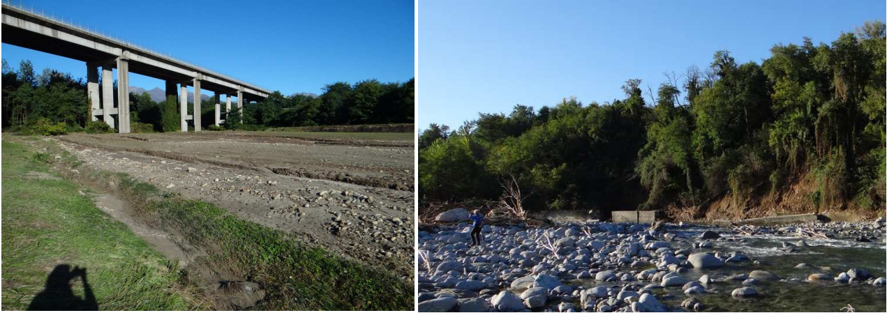
Figura 79 - Nei campi a valle del viadotto, deposizione di materiale sabbioso-ciottoloso e formazione di solchi di erosione (a sinistra); erosione spondale con distruzione parziale della difesa (a destra).
