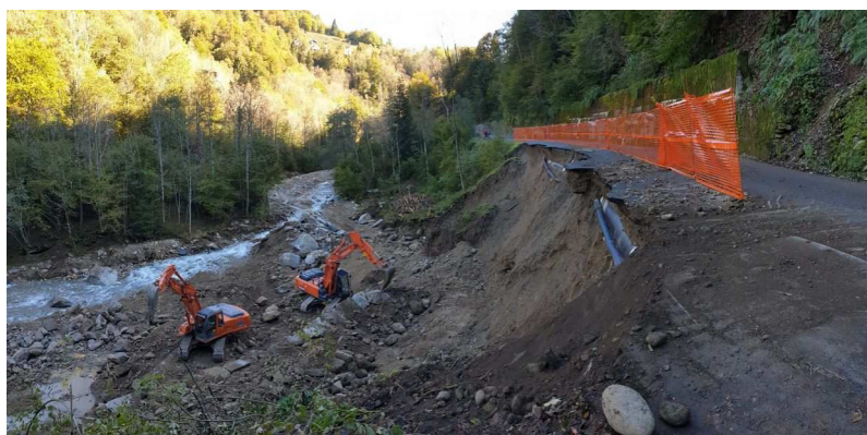
Figura 58 - Sottoescavazione della strada per Camasco per erosione da parte del T. Nono.
