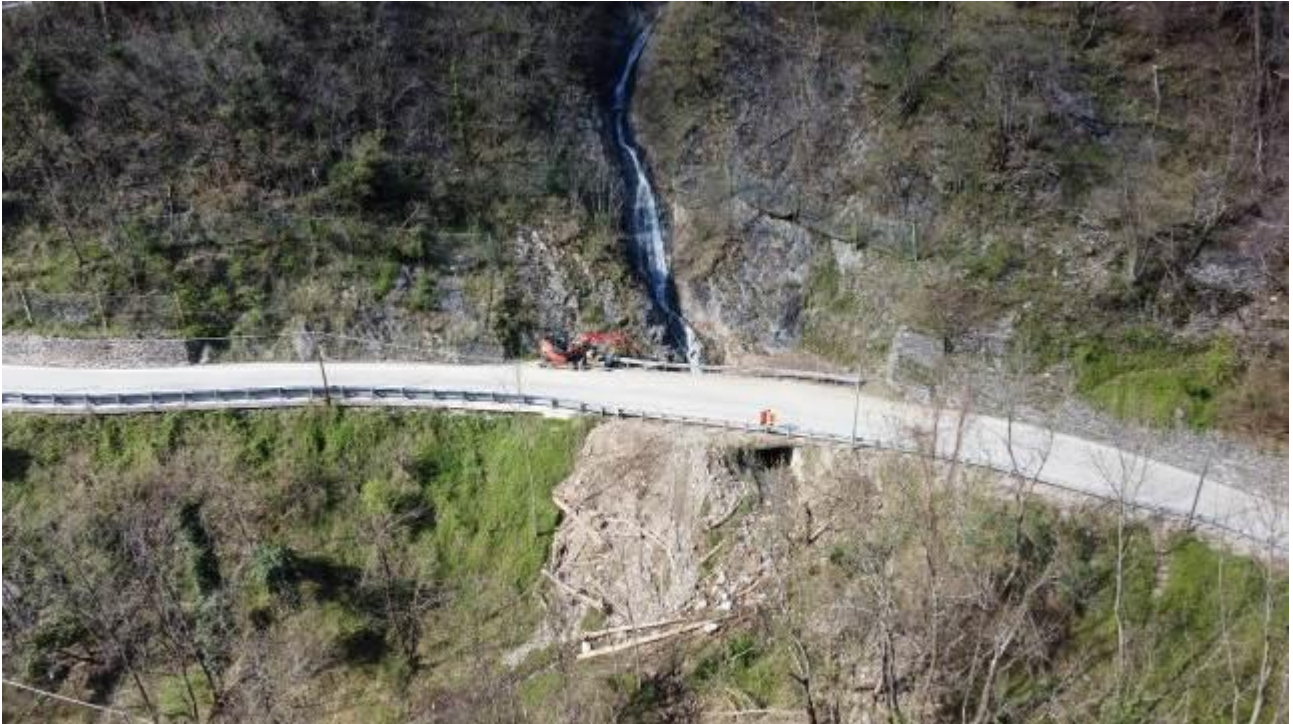
Figura 59 – Operazione di rimozione del materiale che ha invaso la carreggiata della SP 68 di Bognanco (VB). Ripresa da drone effettuata in data 4 aprile da Regione Piemonte
