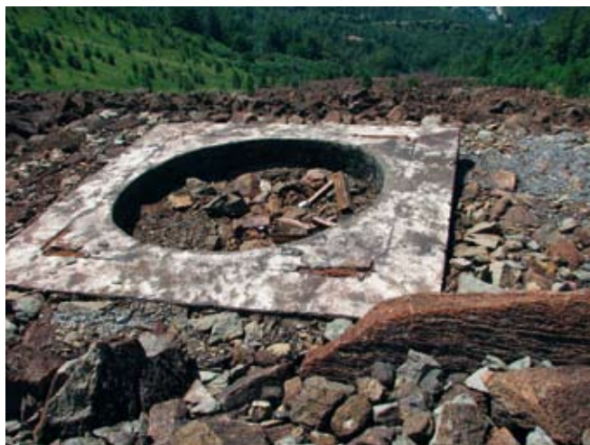
FIG. 6.1 - Base di appoggio in calcestruzzo dei tralicci della vecchia linea elettrica, ora dismessa, costruita sul deposito detritico nell'impluvio tra le loc. Arbarai e Mombas (versante destro della Valle di Viù).
