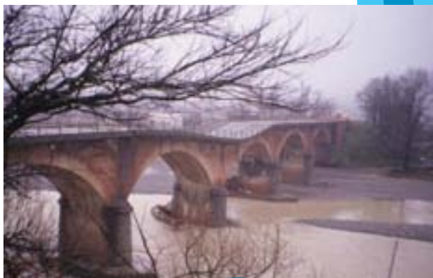
Cedimento della pila di un ponte a causa dell'erosione di fondo
