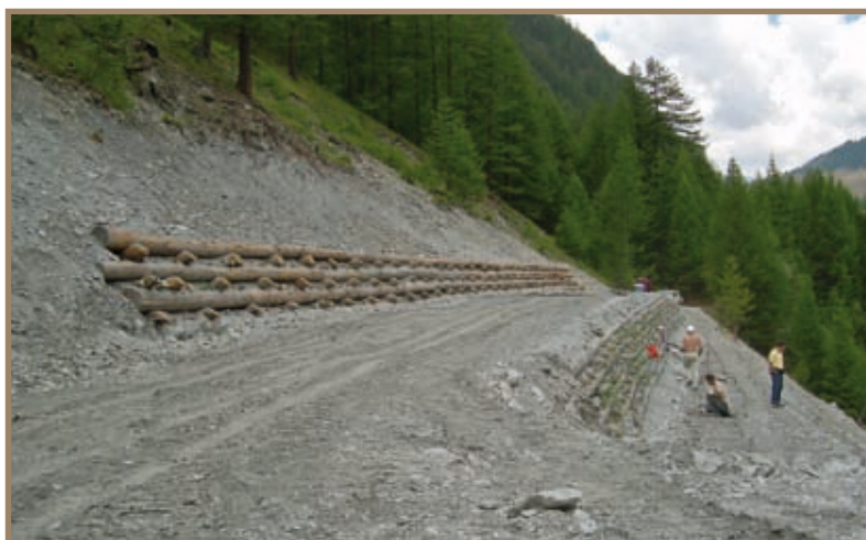
Figura 2.12.12 Palificate di sostegno a doppia parete in versante con caduta massi. L'opera è funzionale alla stabilizzazione del versante ed a proteggere la viabilità forestale diminuendo la pendenza del versante a monte strada
