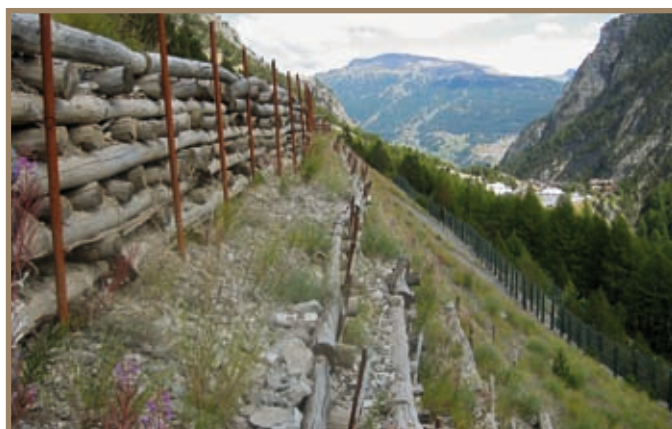
Figura 2.12.16 Lato esterno del vallo paramassi realizzato con successione di palificate di sostegno
