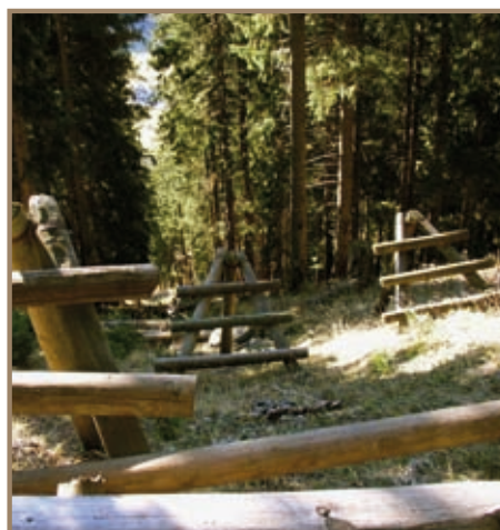
Figure 3.3.112 Exemple de tripodes pare pierres et pare avalanches construits avec des grumes (Autriche, vallée du Montafon). Noter la présence de grume en travers à l'amont des tripodes
