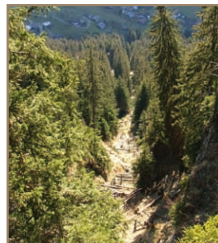
Figure 3.3.116 Exemple d'utilisation de râteliers, tripodes et de grumes pour éteindre un couloir de chutes de pierres et d'avalanches (Autriche, vallée du Montafon)
