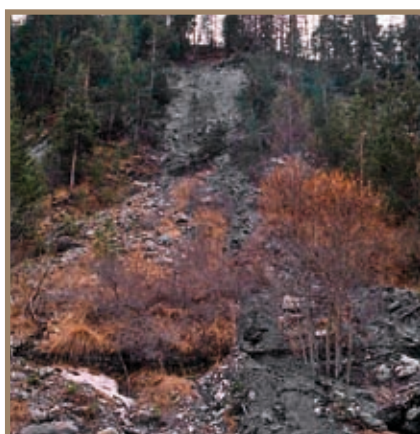
Figura 2.12.13 Impluvi in frana consolidati con palificate di sostegno con funzione di stabilizzazione del detrito di falda contenute trovanti e massi - situazione prima intervento
