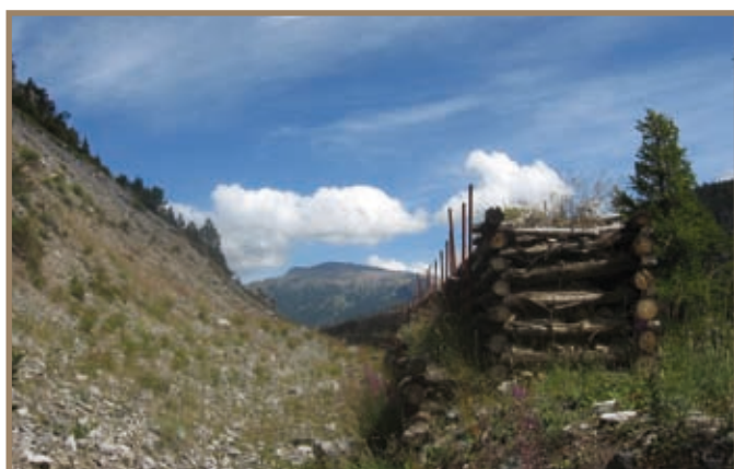
Figura 2.12.15 Vallo paramassi costruito a protezione di Claviere e realizzato con palificate di sostegno a doppia parete in legname
