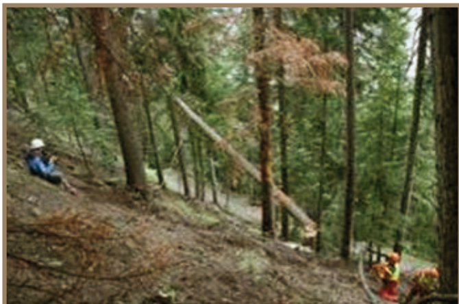
Figure 3.3.88 Chute de l'arbre (2), tension du câble
