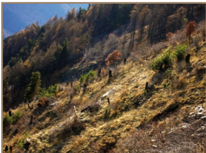
Figura 2.12.7 Infissione di picchetti in legno, taglio piante morte in bosco di protezione (caduta massi e caduta valanghe) percorso da incendio, con realizzazione di palizzate in legname
