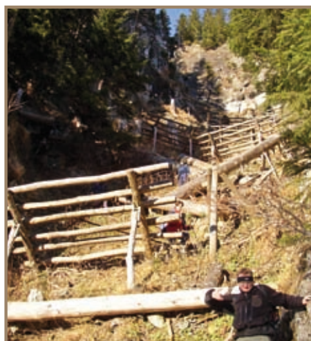
Figure 3.3.115 Exemple de râteliers, tripodes pare pierres et pare avalanches construits avec des grumes (Autriche, vallée du Montafon). Noter la présence de grume en travers au sein et à l'aval du dispositif
