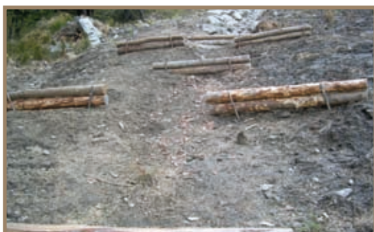
Figura 2.12.10 Palificate semplici all'interno di corpo di frana con potenziale caduta di massi verso la sottostante viabilità forestale
