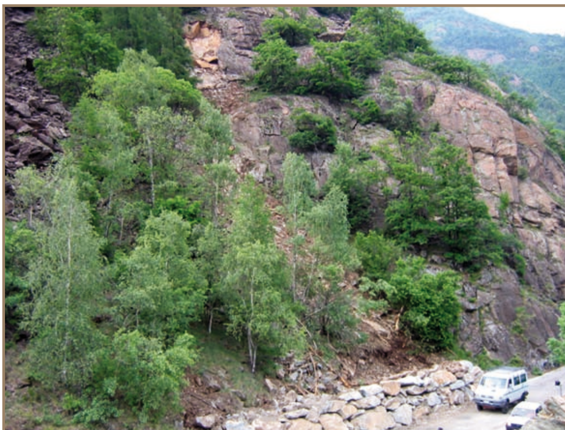
Figura 2.7.19 Crollo avvenuto all'interno dell'area omogenea n° 12 lungo la SP 1 delle valli di Lanzo (maggio 2007). Nella foto sono evidenti le fratture aperte, che hanno favorito il dissesto, e la presenza di alcuni blocchi in equilibrio precario, immediatamente al di sotto della nicchia di distacco
