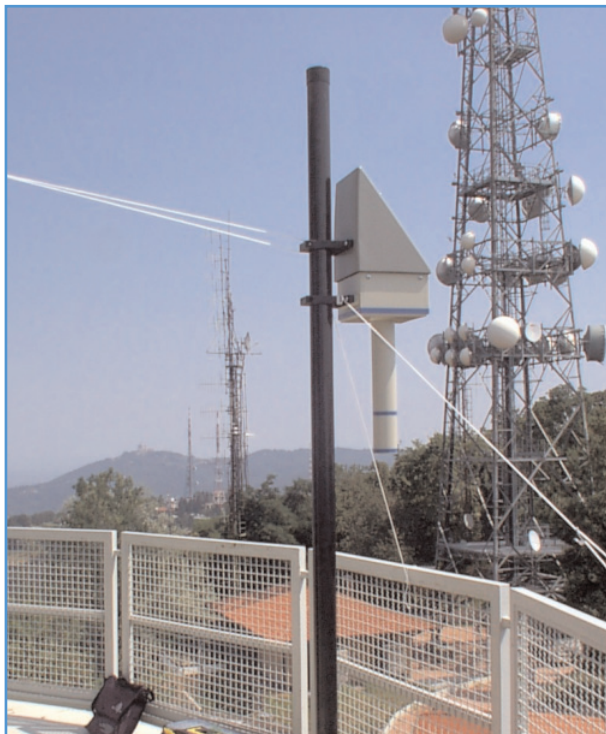
Fig. 76 Centralina per la misura, acquisizione e trasmissione in continua dei valori di campo elettrico a radiofrequenza rilevati presso la postazione "torrino Telecom".
