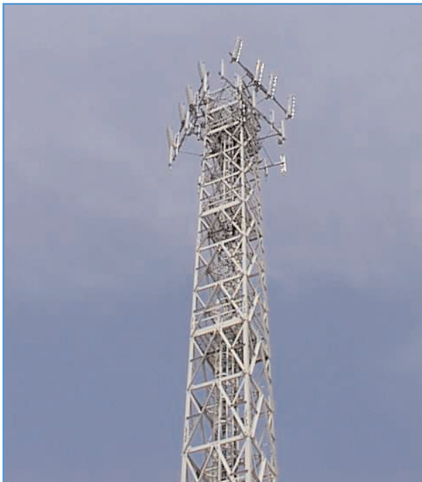
Fig. 2 Stazione radio base per telefonia mobile.
