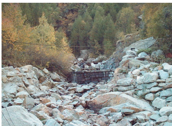
Figura 2.5.12 Particolare di una briglia lungo il Rio Deserta in Valle Orco, che, sebbene in buono stato di conservazione, risulta scarsamente efficace in rapporto a quantità e dimensioni del materiale solido trasportato
