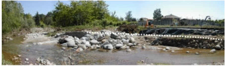
Figura 35: Profonda erosione spondale in corrispondenza dei vivai Scarlatta. La linea tratteggiata bianca indica la sponda precedente all'evento.
