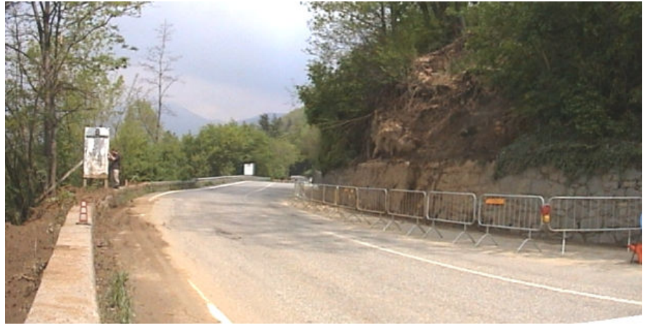
Figura 24: Panoramica del dissesto.
