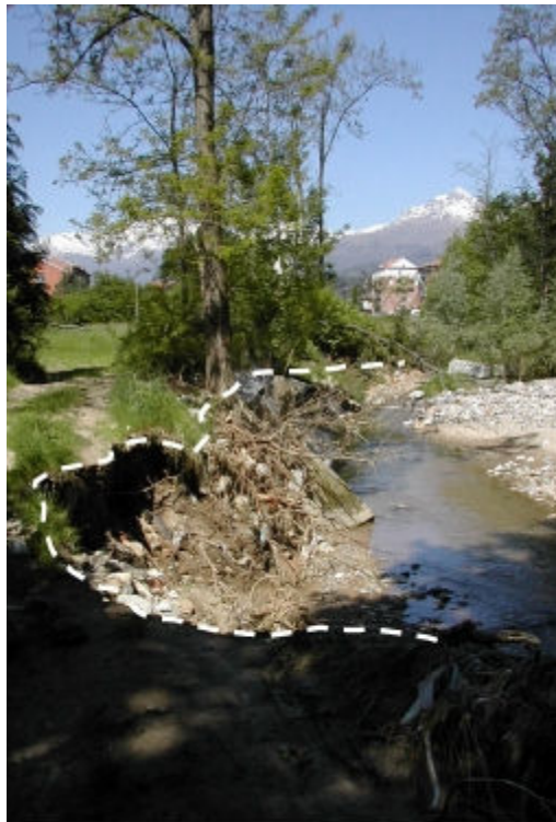
Figura 36: Tratto di sponda erosa lungo il T. Chiebbia in corrispondenza dei vivai Pozzi.
