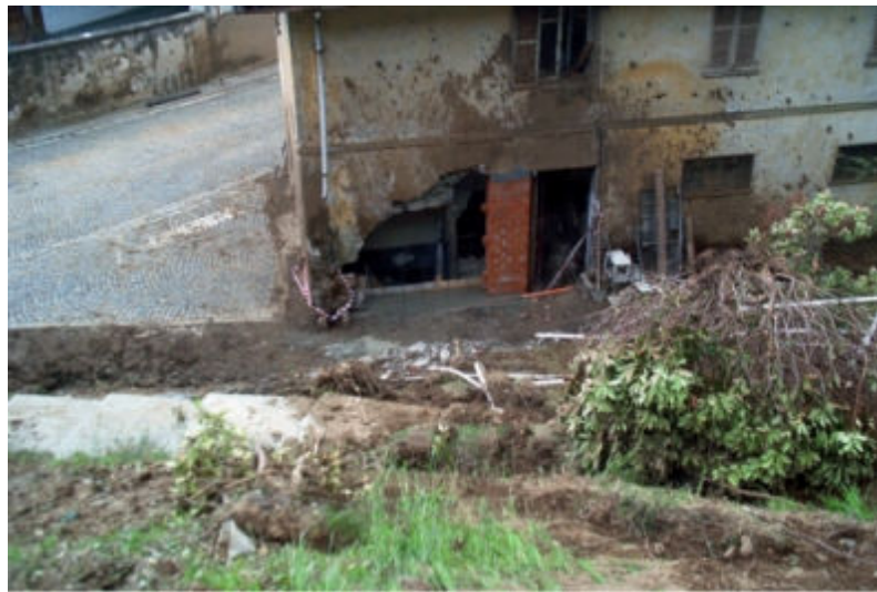
Figura 16: Vista da monte dell'edificio seriamente danneggiato dalla frana per saturazione e fluidificazione della coltre superficiale.
