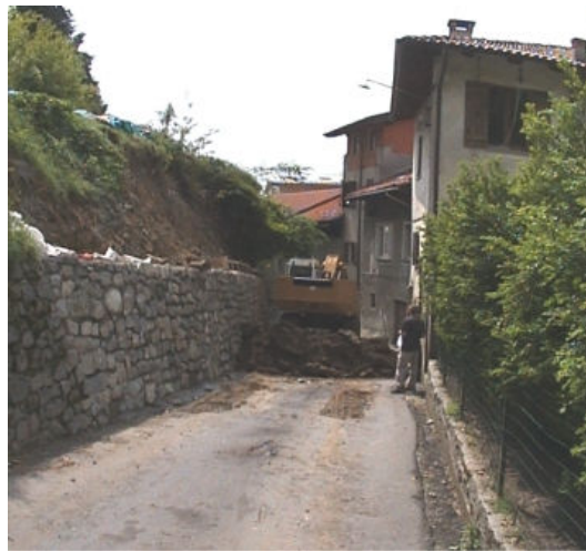
Figura 20: Area di distacco della frana con materiale ancora in loco.
