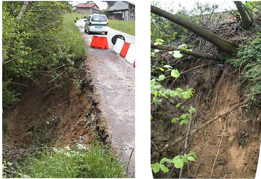
Figura 18 Nicchia di distacco (A) e particolare sul materiale coinvolto (B).
