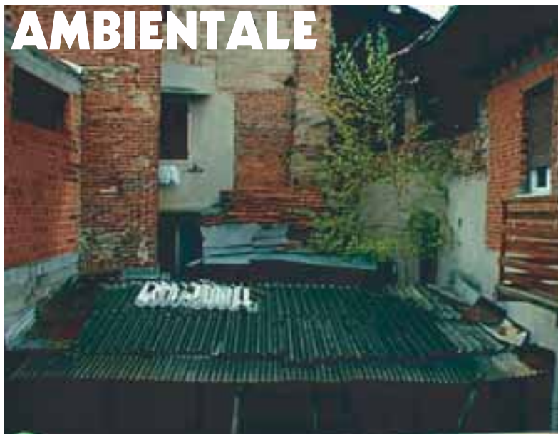
Tettoia in cattivo stato di conservazione
