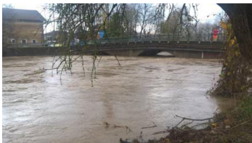
Figura 6. Comune di Volvera; ponte della SP141 visto da monte nella mattinata del 25 novembre 2016 - le acque sono in fase di ritiro (foto comune di Volvera)
