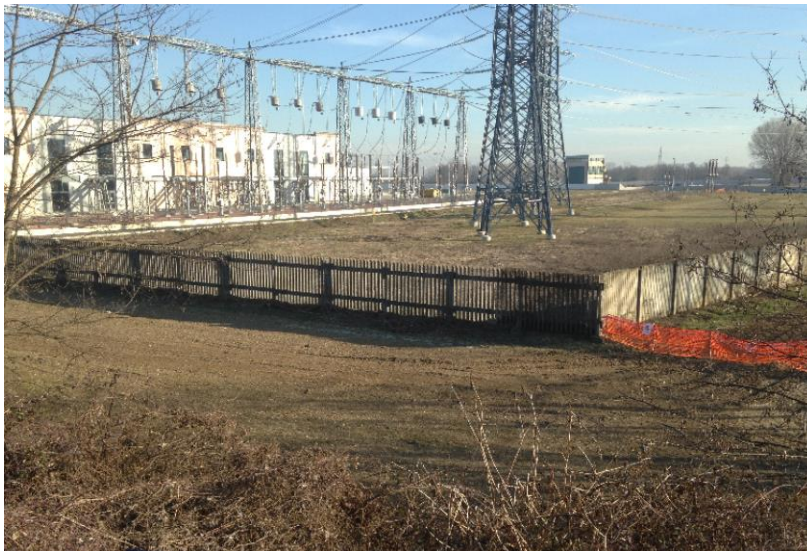
Figura 3. Comune di Piossasco, centrale Terna; aree verdi coinvolte nella dinamica dei deflussi e stazione elettrica, rialzata, non interessata dagli allagamenti
