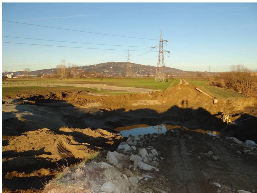
Figura 12. Breccia nell'argine nel tratto nord a valle del ponte di Strada Barauda
