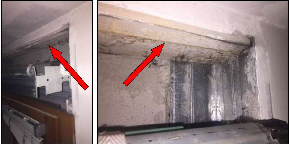
Figura 16: Palazzina D0 – cassonetto dell'avvolgibile aperto – in evidenza il listello in legno nella parte superiore del cassonetto che funge da battuta per il coperchio
