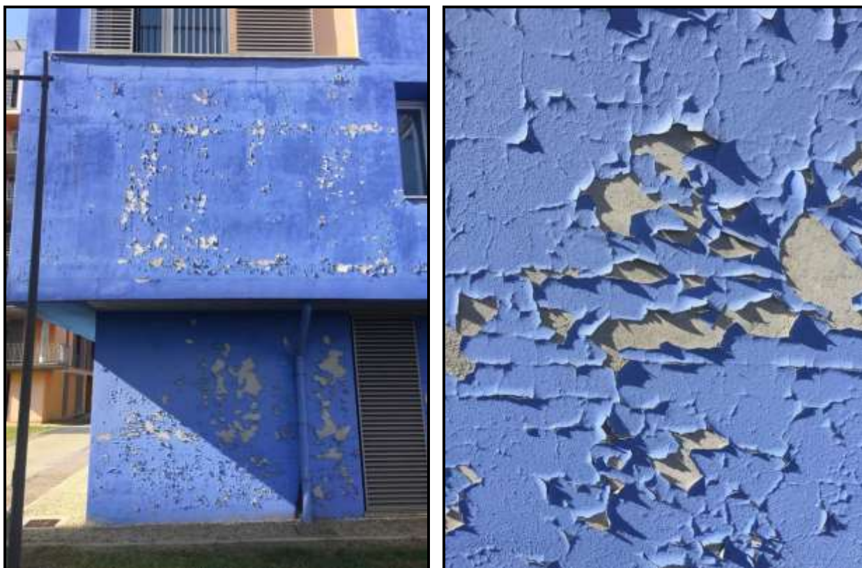
Figura 12: Palazzina C1 – in evidenza il distacco della tinta dall'intonaco
