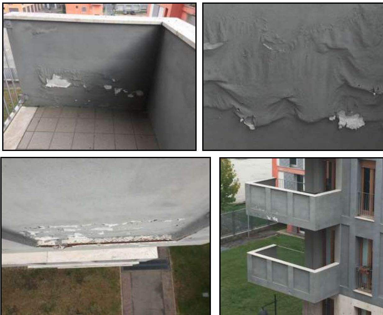
Figura 8: Palazzina B2 – in evidenza il rigonfiamento dell'intonaco e il distacco delle parti danneggiate con il paraspigoli in metallo esposto
