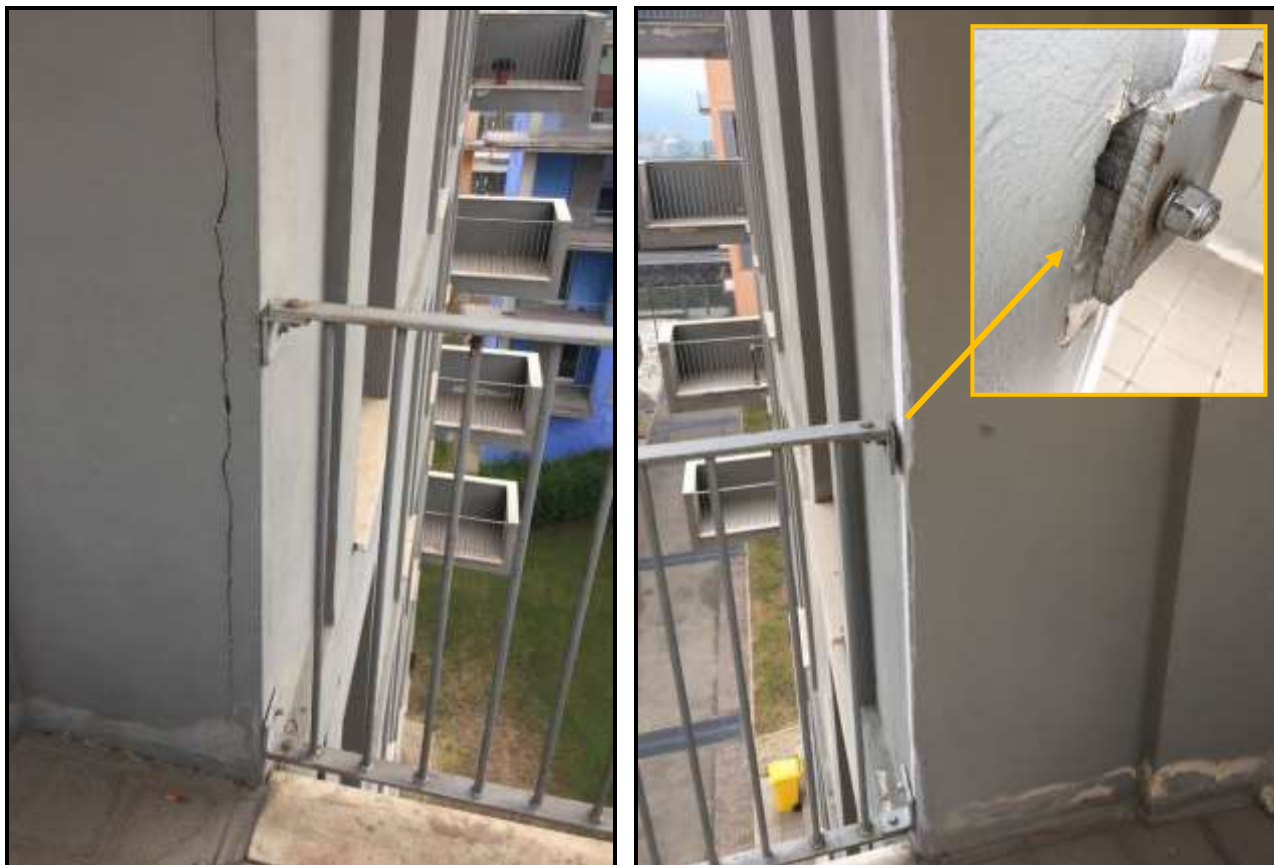
Figura 8: Palazzina B2 – in evidenza la lesione dello spigolo causata dalla vite correttamente immorsata e sottoposta a trazione (sx) e, viceversa, lo sgretolamento della malta laddove la vite non è stata immorsata a sufficienza nella muratura d'angolo (dx).
