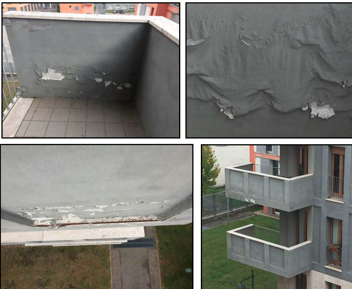
Figura 8: Palazzina B2 – in evidenza il rigonfiamento dell'intonaco e il distacco delle parti danneggiate con il parasigoli in metallo esposto
