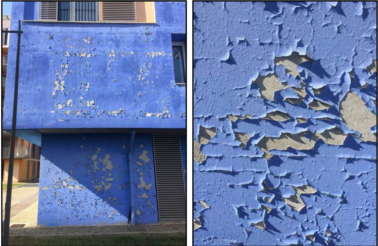
Figura 12: Palazzina C1 – in evidenza il distacco della tinta dall'intonaco
