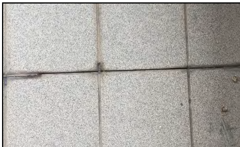
Figura 7: Palazzina B2 – in evidenza l'apertura del giunto (fuga) nelle piastrelle del piano di calpestio
