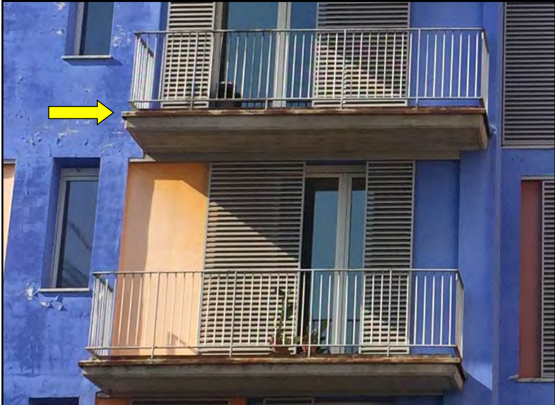
Figura 13: Palazzina C1 – in evidenza la corrosione delle parti metalliche
