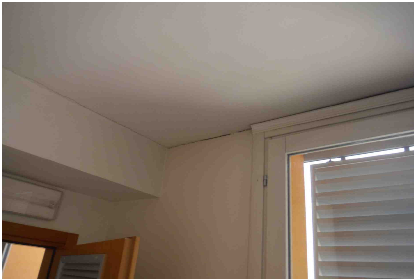
FESSURA DI SCOLLAMENTO MURO DA SOLAIO AL 6° PIANO
