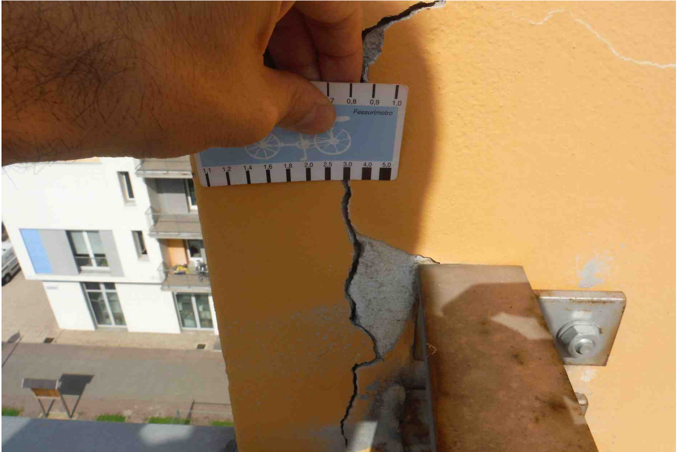
DISTACCO PARAMENTO VANO SCALA IN PROSSIMITA' DEL PARAPETTO AL 6° PIANO
