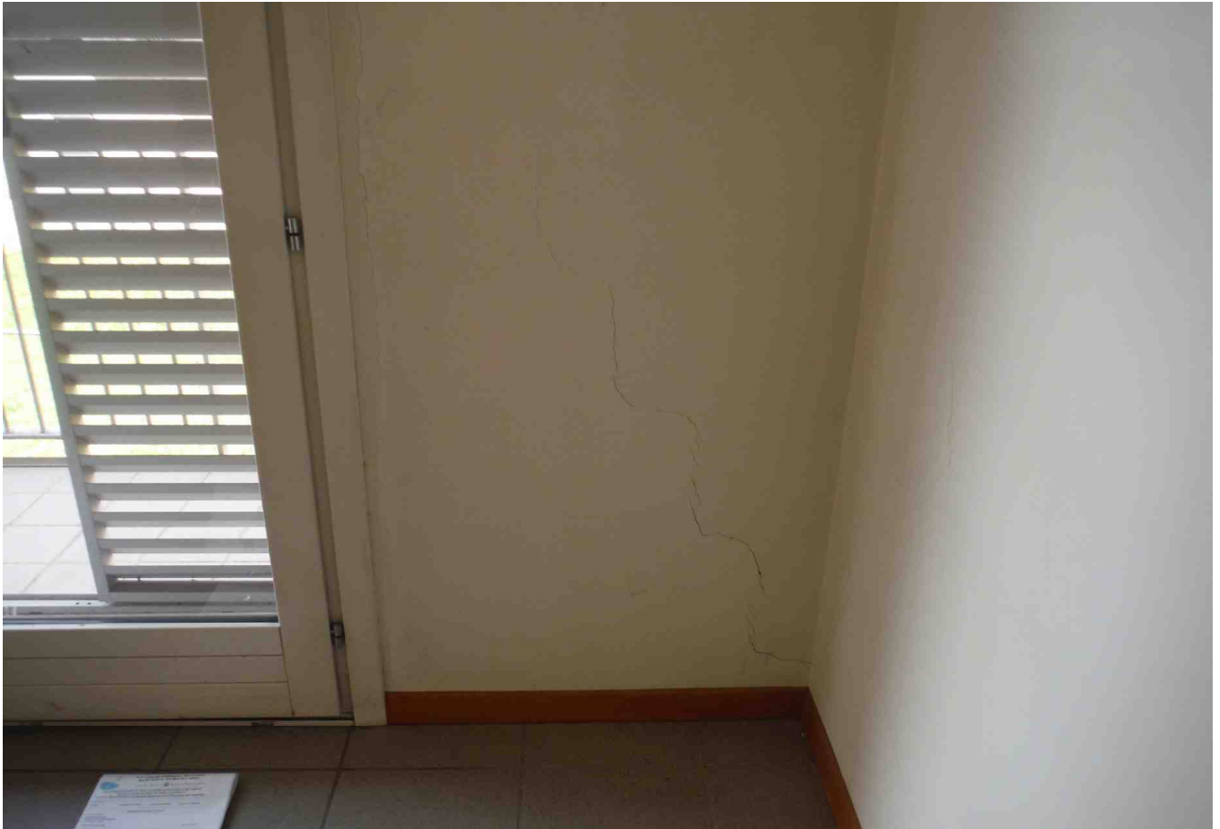
PIANO PRIMO, FESSURA "SCALETTATA"
