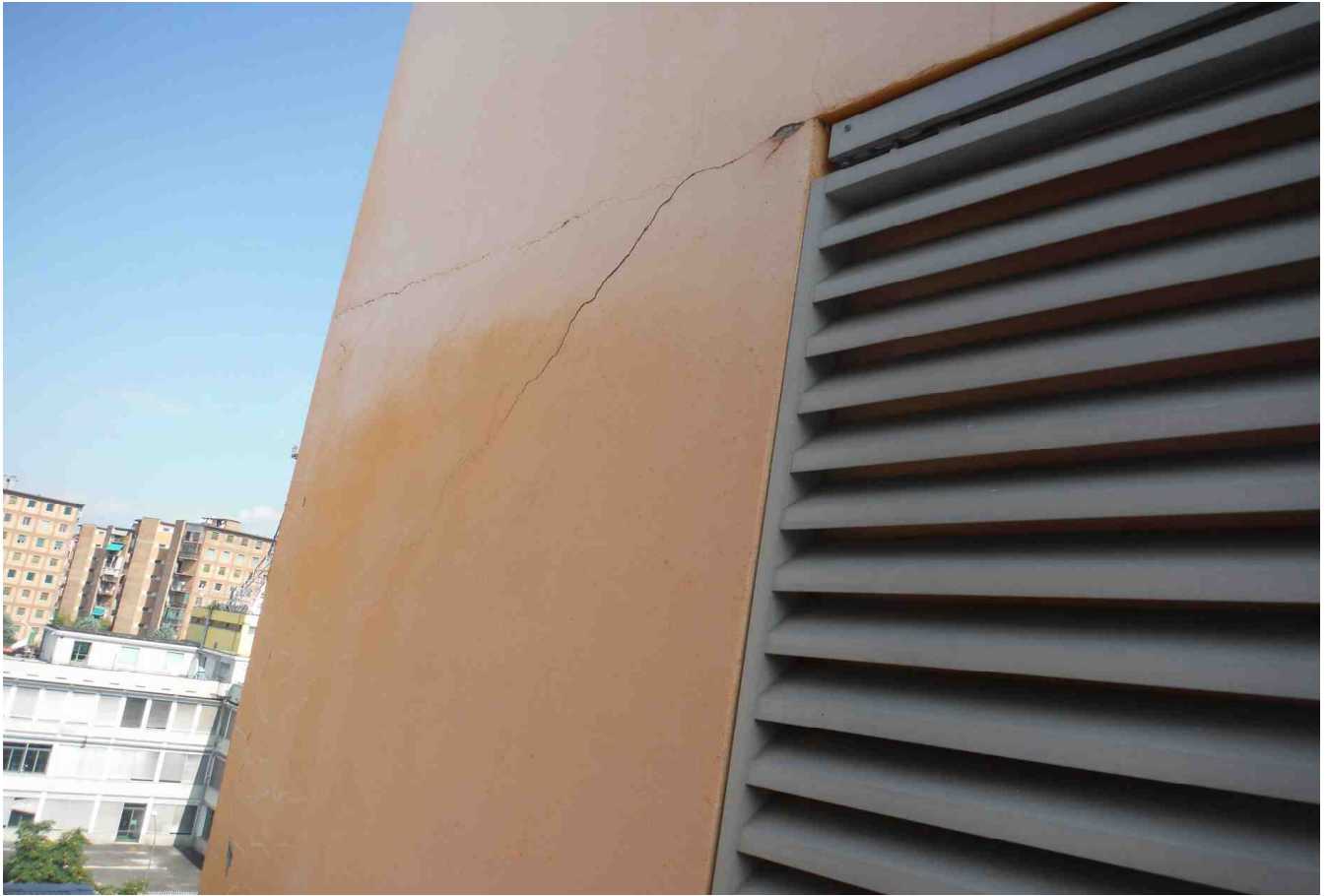
FESSURA SULLO STESSO MURO ESTERNO, 6° PIANO
