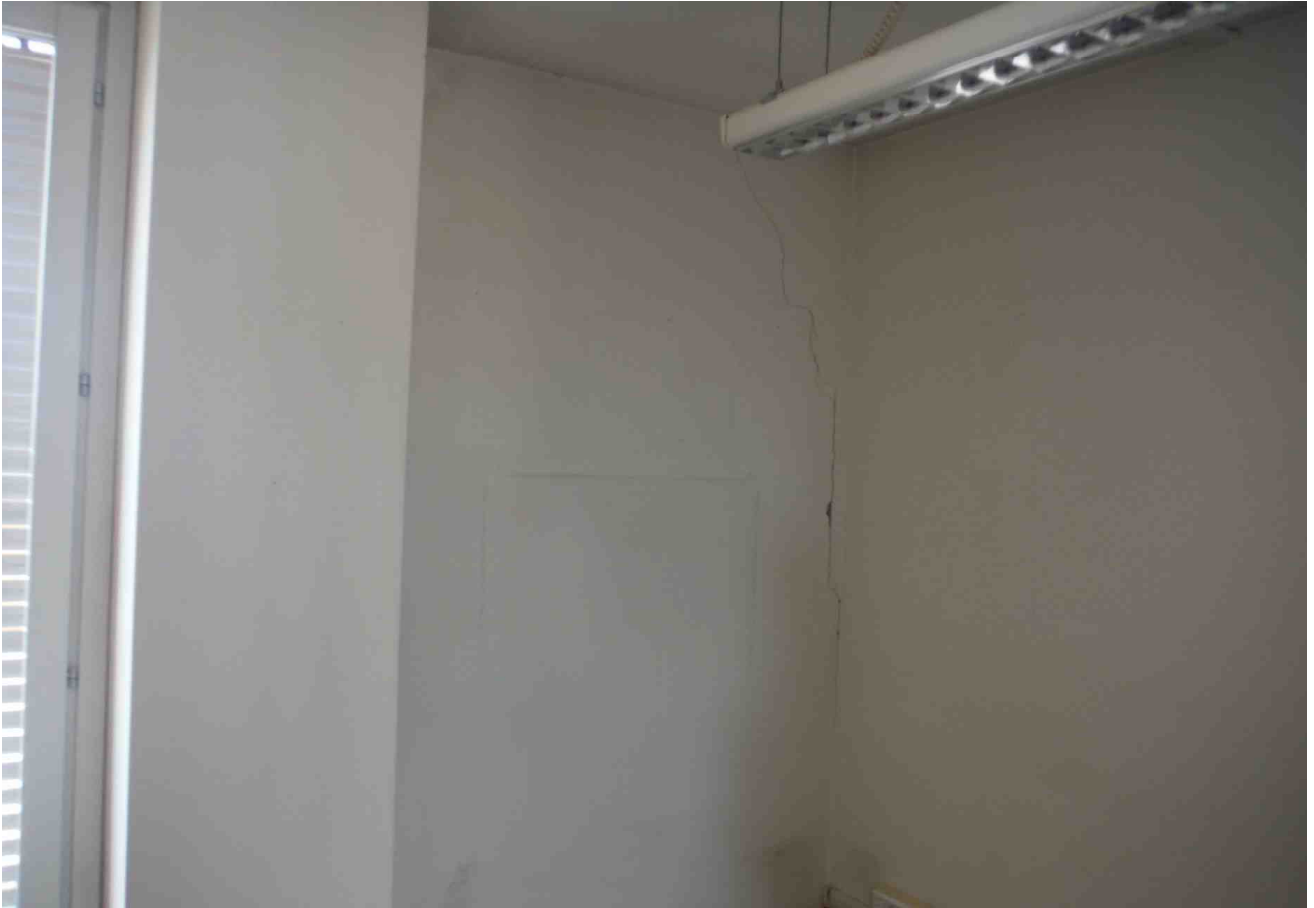
FESSURA DI SCOLLAMENTO MURO DA SOLAIO E LESIONE CON MURO ADIACENTE, 6° PIANO
