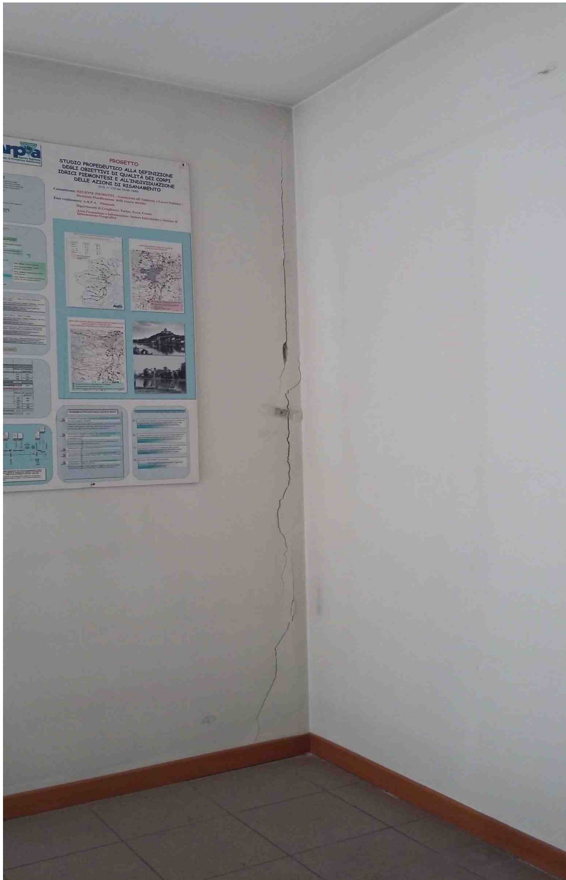
PIANO PRIMO, FESSURA ADIACENTE PILASTRO IN FALSO
