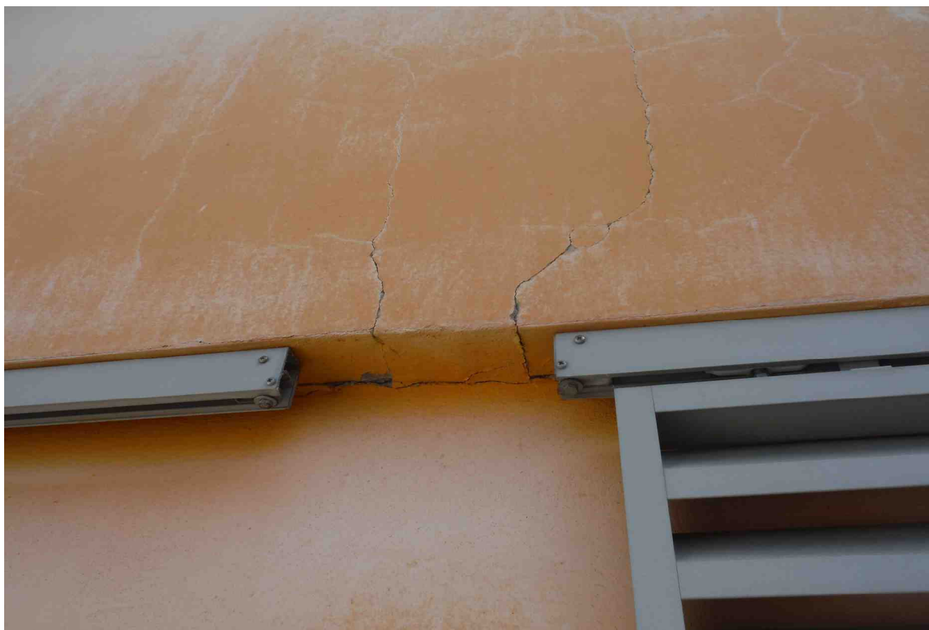
FESSURA VERTICALE STESSO MURO, 6° PIANO
