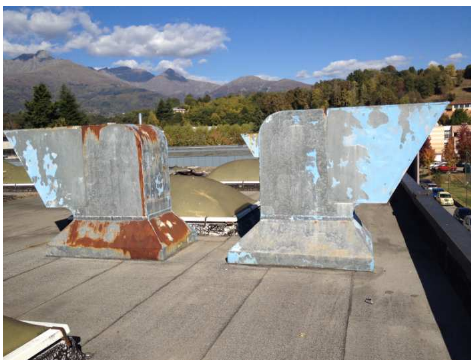
Impianti esistenti da mantenere
