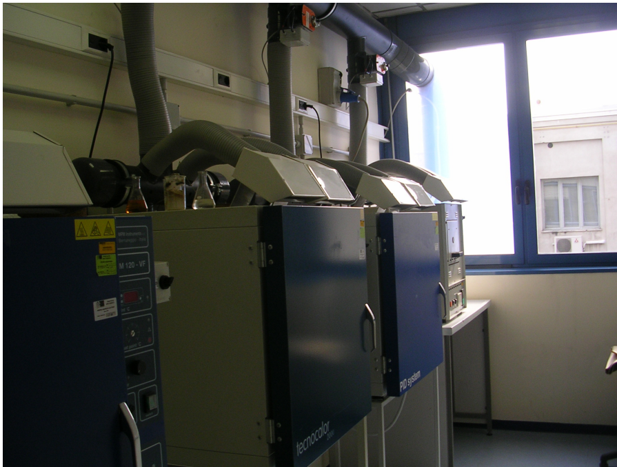
Figura 1: esempio di sistema di aspirazioni localizzate
