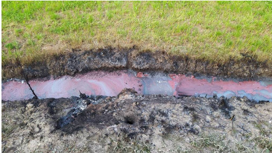
Foto 2- Canali interessati da vernici e acque di spegnimento
