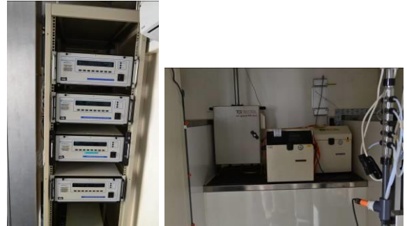
Figura 3: Mezzo mobile dell'ARPA Piemonte e strumentazione allestita
