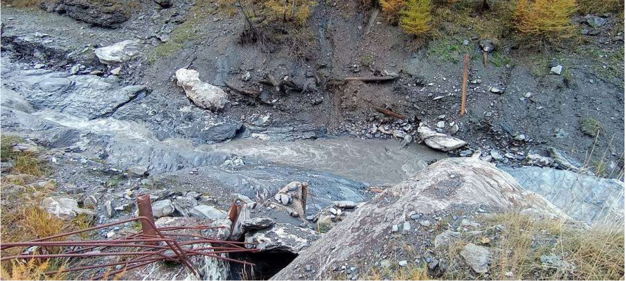
Figura 61 - Briglia a quota m 1714 ripresa in seguito all'evento torrenziale del 13 agosto 2023: completa distruzione della gaveta.
