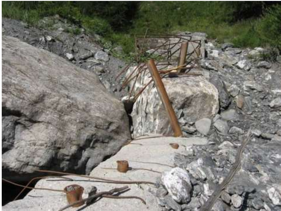
Figura 60 - Briglia a quota m 1714 ripresa nell'anno 2007. Si nota il forte ammaloramento del calcestruzzo e l'assottigliamento dei ferri di armatura nella direzione della corrente (da destra verso sinistra).
