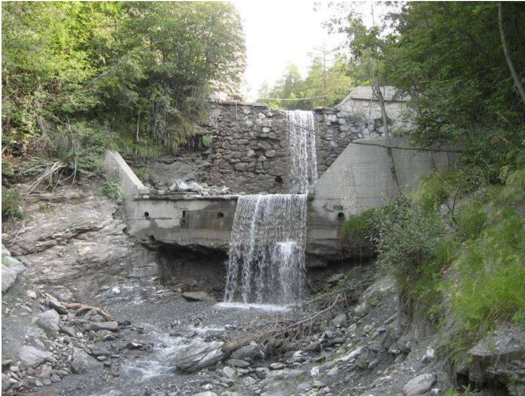
Figura 70 - Briglia in apice del conoide, alla quota m 1371 ripresa nell'anno 2011 in cui si evidenzia lo scalzamento della controbriglia.
