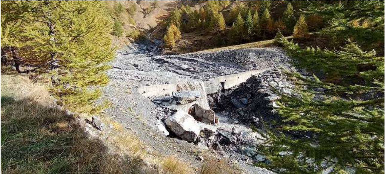
Figura 59 - Briglia a quota m 1732 ripresa dopo l'evento torrentizio dell'agosto 2023.
