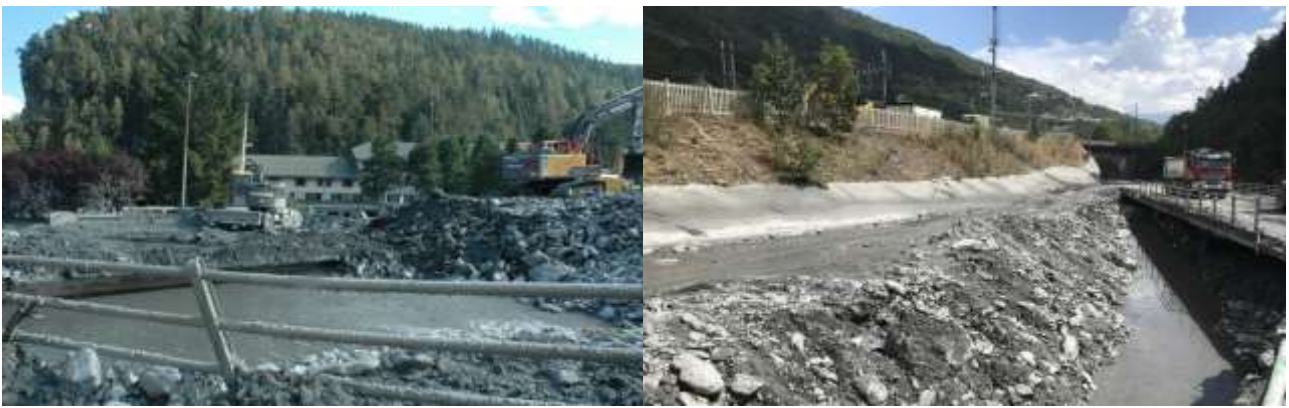
Figura 33 – Ponti di via Stazione (a sinistra) e di via Torino (a destra) completamente occlusi, nelle foto rispettivamente del 14 agosto e del 16 agosto dopo i primi interventi di ripristino.
