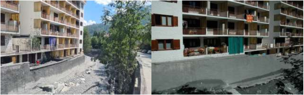
Figura 30 – Edificio in sinistra idrografica posto poco a valle del ponte di Via Medail interessato dalla colata detritica. Gli stessi edifici erano stati lambiti dalla colata del 2009 e 2004.
