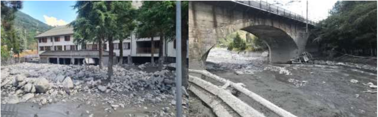
Figura 39 – A sinistra, area antistante il Commissariato di Polizia, completamente intasata di deposito grossolano. A destra, Attraversamento della ferrovia, visto da monte
