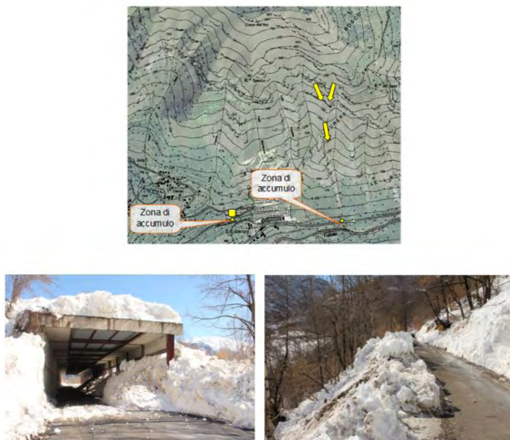
Figura 4.10: in alto localizzazione cartografica della valanga, le frecce indicano le zone di distacco, il punto giallo la porzione di strada interessata dalla valanga. In basso a sinistra il paravalanche della strada Valdieri-S.Anna, a destra la strada Valdieri-S.Lorenzo.
