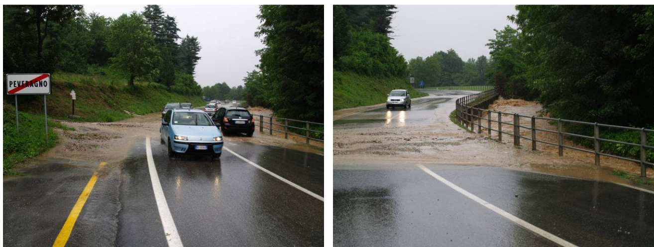
Figura 35. Comune di Peveragno. Allagamento della strada che collega Boves con Peveragno a causa delle acque ruscellanti provenienti dal versante a monte (a sinistra); allagamento e debole alluvionamento della strada all'ingresso in Peveragno, sulla destra dell'immagine il rio Bedale in piena (a destra)
