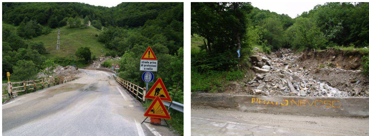
Figura 34. Comune di Frabosa Sottana. Settore della S.P. 327 coinvolto dal processo di trasporto in massa lungo il rio proveniente dalla conca di Prato Nevoso (a sinistra); alveo del rio interessato dal processo di trasporto in massa immediatamente a monte della S.P. (a destra).
