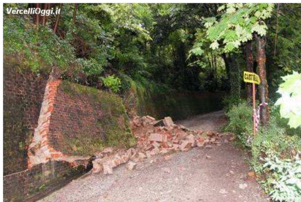
Figura 38. Comune di Camino. Le piogge hanno fatto cedere una parte del muro di recinzione dello storico Castello San Pietro. Foto Vercelli Oggi ( www.vercelliooggi.it )
