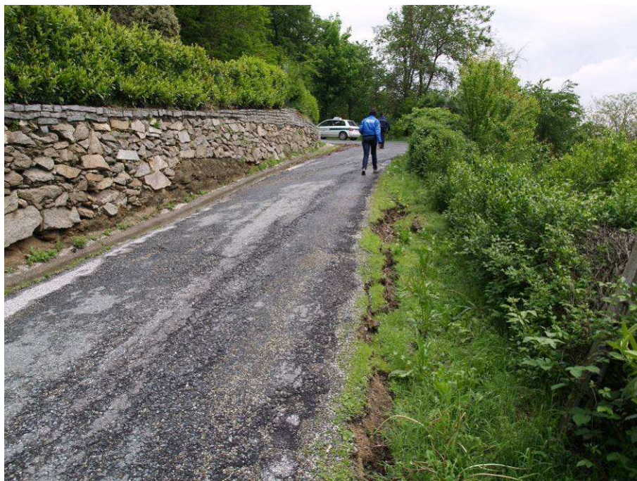
Punto 2 – Cedimento della strada comunale per la sommità della rocca
