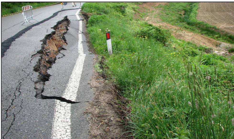
Danno al sedime stradale e coronamento del movimento rilevato
