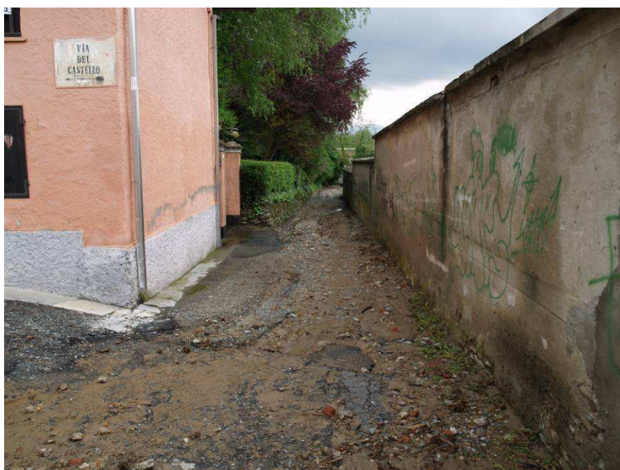
Punto 1 – Strada comunale invasa dal materiale detritico franato
