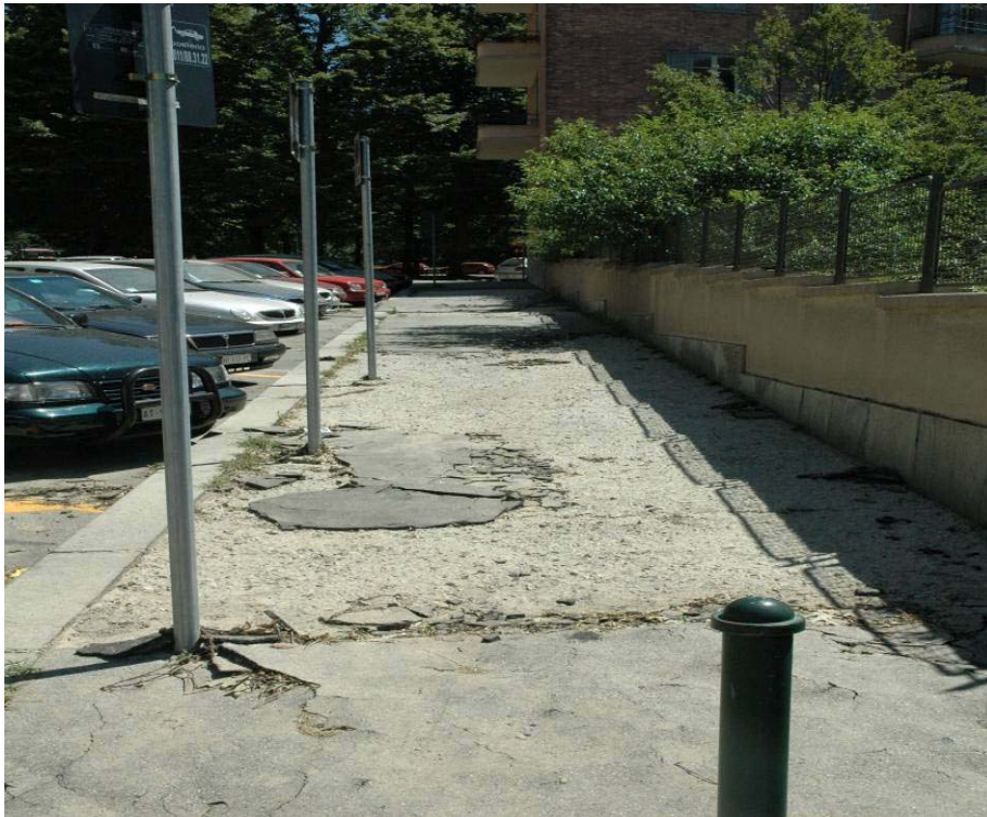
Figura 4. Via Cavalcanti: asfalto asportato.
