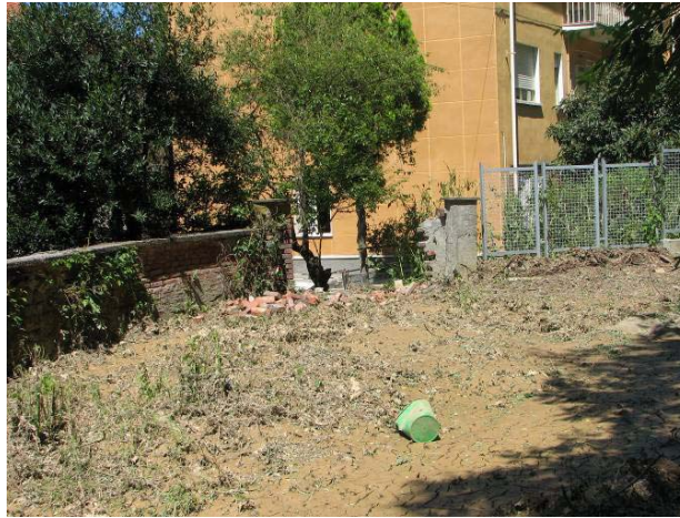
Figura 6. Muro perimetrale abbattuto dal ruscellamento concentrato.
