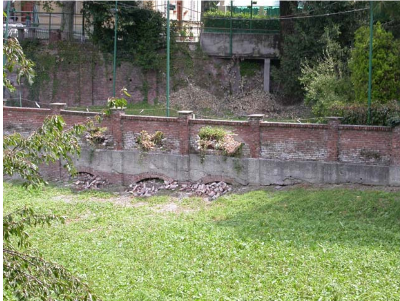
Figura 10. In evidenza il danno al muro di cinta in Località Rio San Martino
