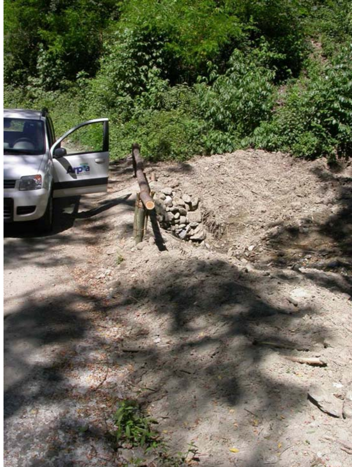
Figura 13. Attraversamento realizzato con tubi in c.a. . Il trasporto solido ha intasato completamente i tubi (accumulo di detriti a destra) provocando il rigurgito delle acque lungo la sede stradale. La figura è rappresentativa di un fenomeno molto diffuso e frequente nell'area collinare.
