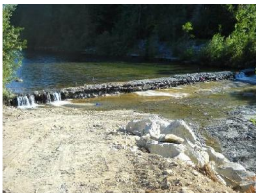
Lavori di messa in sicurezza dell'attraversamento fognario a monte del ponte ferroviario (agosto 2012).
