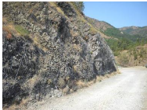
Versante sx: SP207 e reti paramassi - limitazione della connessione dell'alveo con i versanti (agosto 2012).
