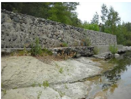
Muro di difesa spondale parzialmente scalzato, a monte della loc. Monteggio (agosto 2012).
