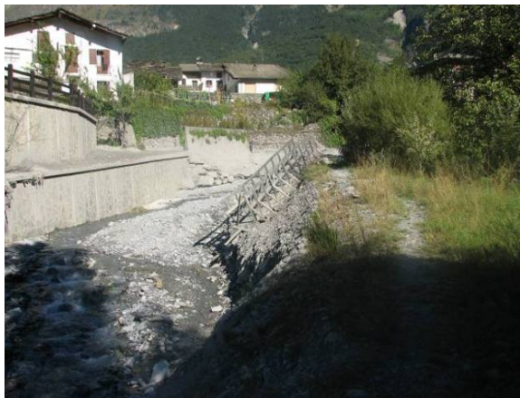
Fig. 15 - Vista verso monte della passerella asportata in corrispondenza dell'ansa a monte del ponte.
