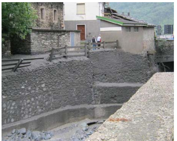
Fig. 17 - Tracce dell'altezza dei deflussi da fondo alveo a monte del ponte in Novalesa.
