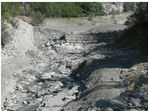
Fig. 22 Vista verso monte del danno al muro di contenimento della vasca di espansione in apice di conoide
