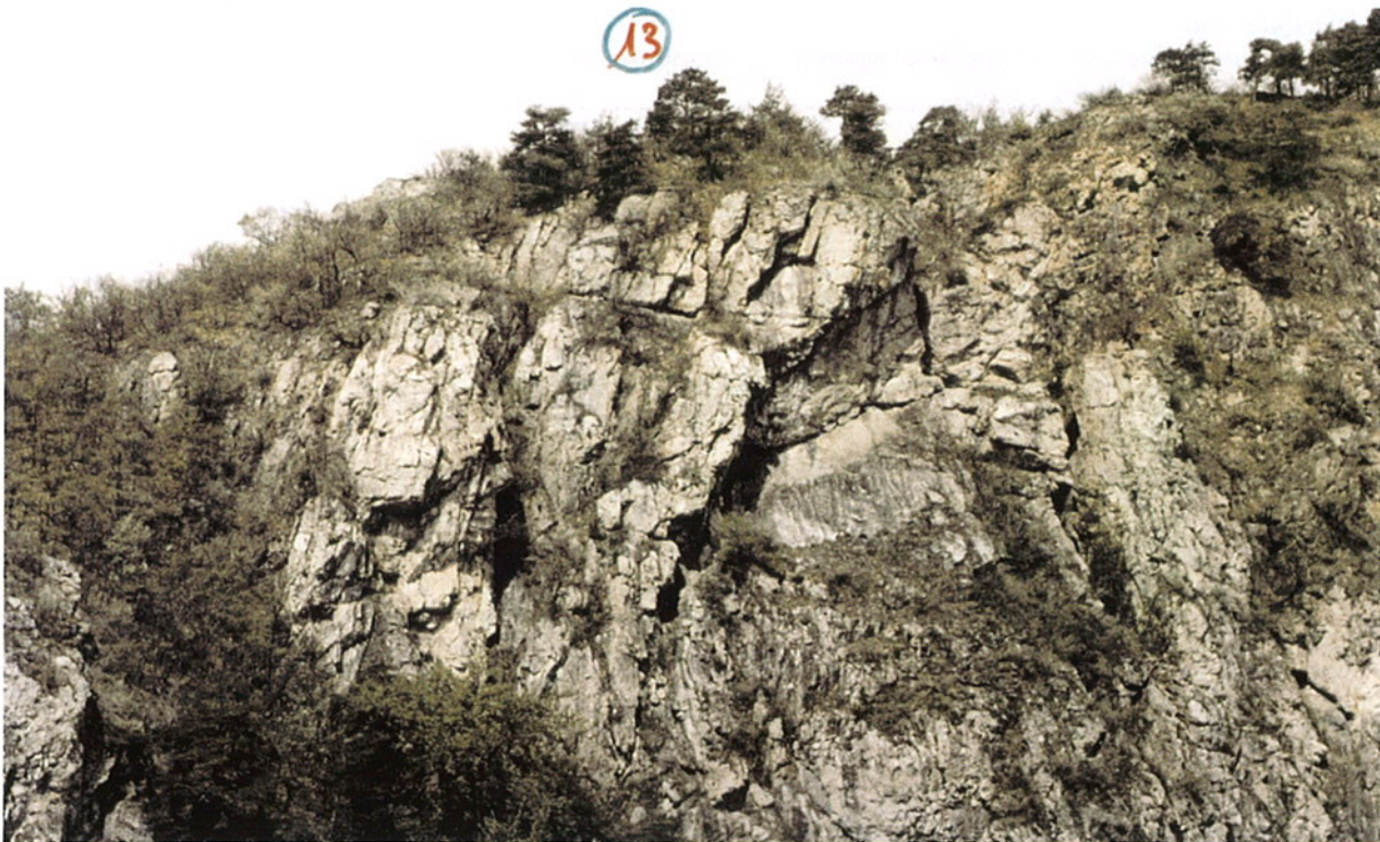
Fig III.34 : Vallée de la Tarentaise – Savoie – Secteur d'étude n°2 - Exemple de Compartiment instable (n° P2-13) - Schistes Foliation subverticale Glissement dièdre - Dislocation.
