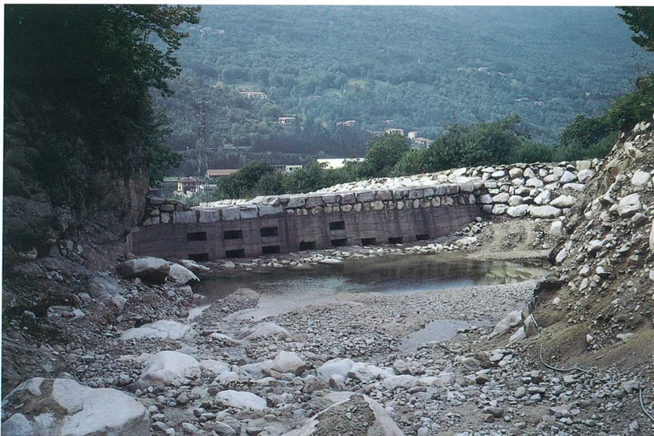
Fig. 15. Omegna, Rio Inferno. Briglia di tipo selettivo con vasca di accumulo (capacità 15.000 m 3 circa), realizzata in apice di conoide (q. 315 m circa).
