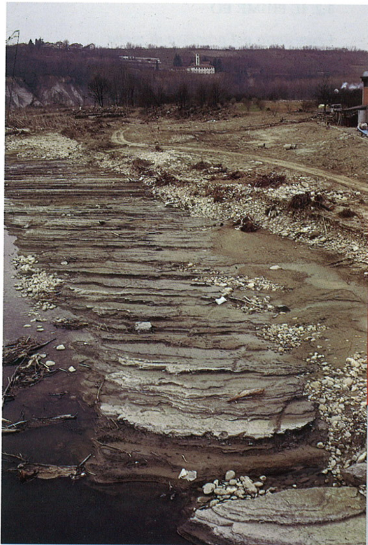
Fig. 54. Comune di Farigliano, loc. Naviente. Esposizione del substrato marnoso a seguito di erosione laterale dei depositi alluvionali in sponda destra del canale del fiume Tanaro.
