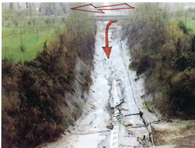
Fig. 25. Comune di Farigliano, loc. Valetti. Fotografia aerea, da valle, della trincea artificiale a servizio della strada di fondovalle. Le acque di piena si sono incanalate entro il manufatto asportando completamente il rilevato stradale, convolvendo alcune autovetture in transito e causando una vittima.
