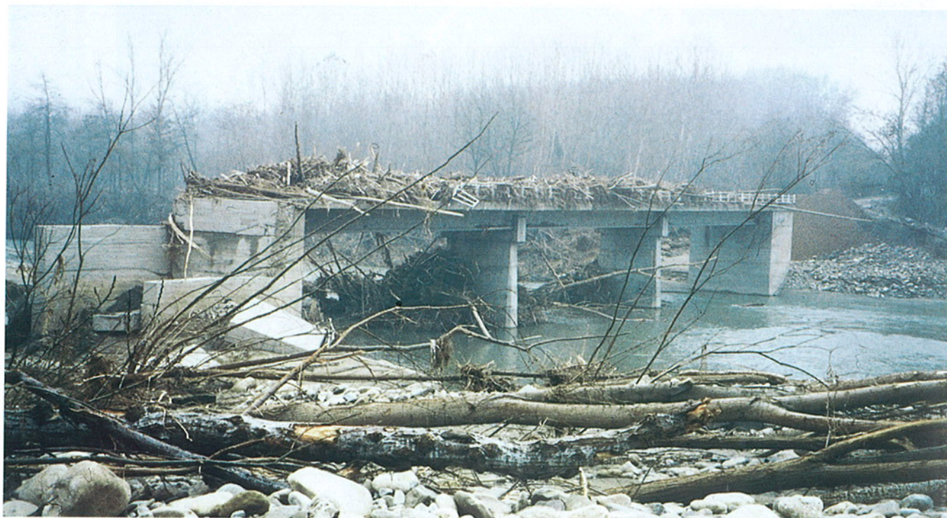
Fig. 13. Immagine del ponte posto a valle di Niella Tanaro: risultano completamente erosi sia i due rilevati di accesso che ampia parte della strada provinciale posta in sponda destra.
