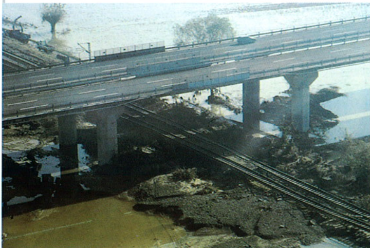
Fig. 46. Alessandria, frazione Astuti. Novembre 1994: rotta del rilevato ferroviario Torino-Genova.
