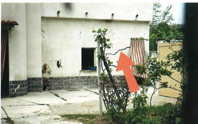
Fig. 50. Alessandria, Borgo Cittadella, novembre 1994. Cedimenti differenziali a carico delle opere murarie che hanno presentato attività per molto tempo dopo l'evento alluvionale.
