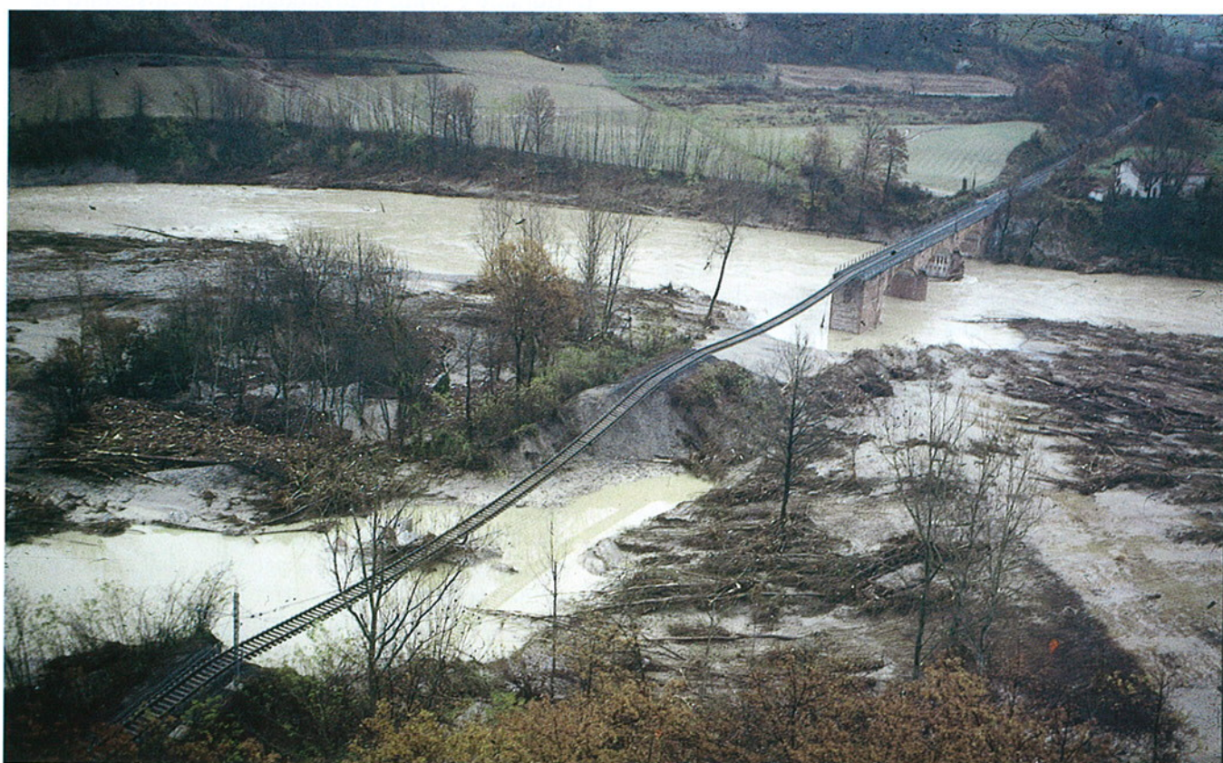
Fig. 16. Comune di Castellino Tanaro, località Nicape. La poderosa azione di erosione ha asportato quasi del tutto il lungo rilevato ferroviario posto in sinistra del fiume.
