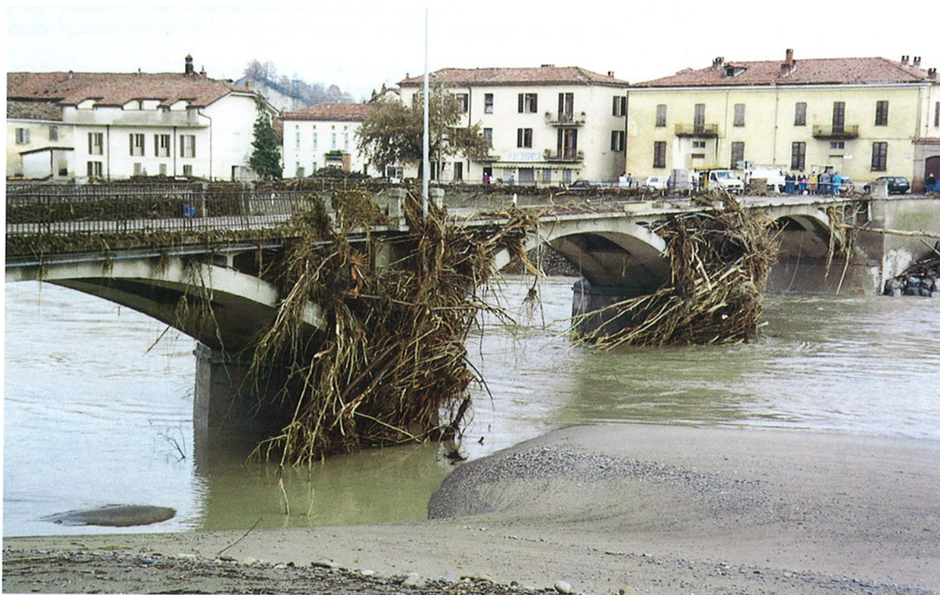
Fig. 18. Comune di Bastia Mondovì. Le evidenti tracce lasciate dalla vegetazione fluitata con la piena del fiume Tanaro testimoniano il sormonto della infrastruttura avvenuto la sera del 5 novembre 1994.
