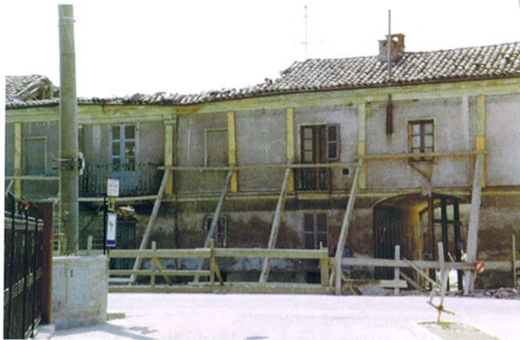
Fig. 44. Edifici di Castello di Annone lungo la SS 10 pesantemente danneggiati.
