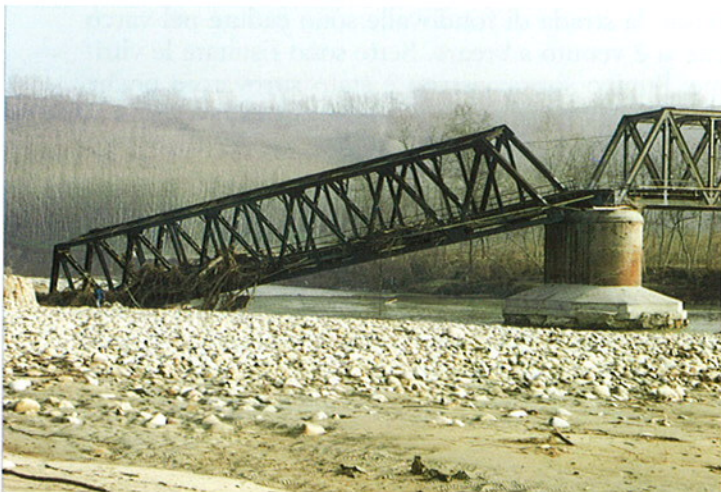
Fig. 28. Comune di Piozzo, località C. Vacchella. La campata metallica del ponte ferroviario appoggia sul greto dopo l'asportazione del rilevato in sinistra.
