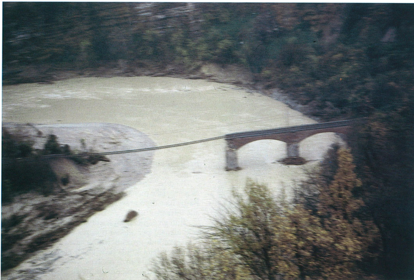
Fig. 15. Dintorni di Bastia Mondovì, località Preosa. Scomparsa del rilevato posto in sinistra del ponte ferroviario per erosione fluviale a seguito della piena.
