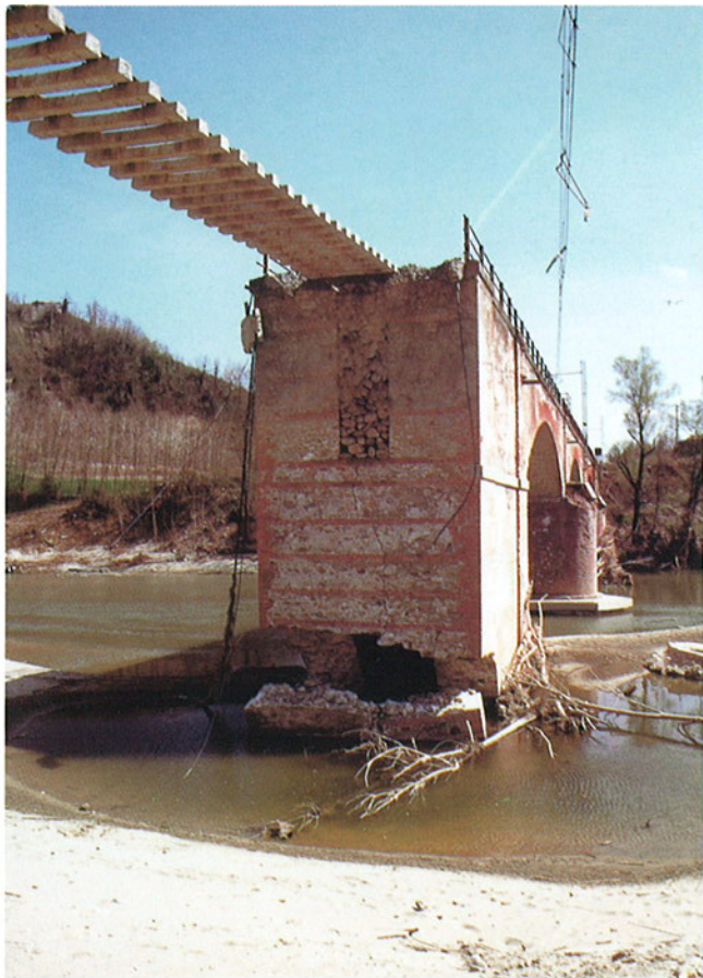
Fig. 17. Particolare della fotografia precedente nel quale è evidente la lesione alla pila di sinistra per sottoescavazione della fondazione.
