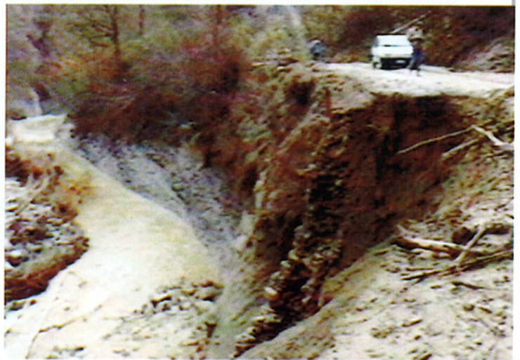
Fig. 1. Rio Bovina, Comune di Ceva. L'eccezionale livello raggiunto dall'acqua ha provocato profonde erosioni laterali e gravi danni alla rete stradale.
