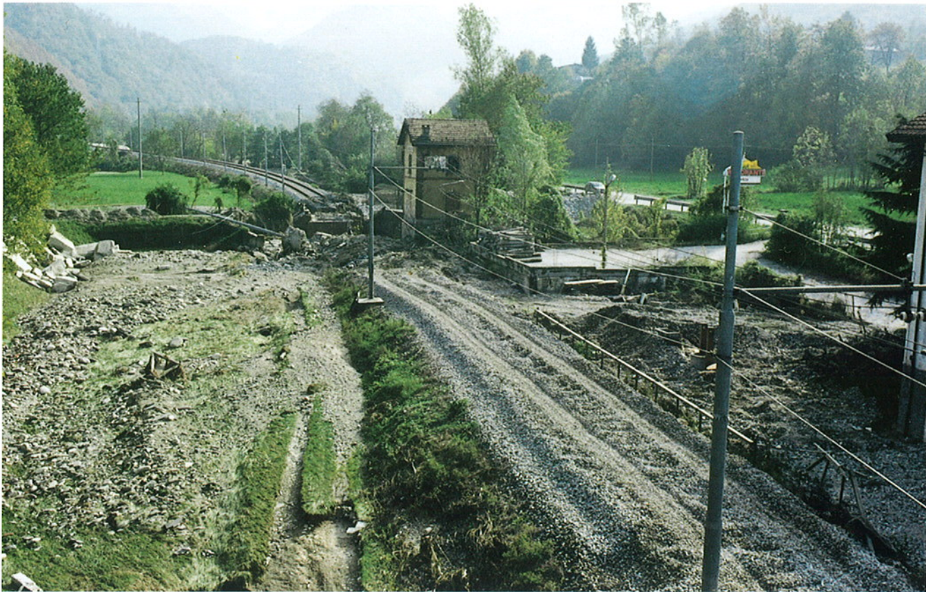
Fig. 7. Comune di Robilante. Vista generale da valle verso monte della linea Cuneo-Nizza, presso il bivio della S.S. n. 20 per Tetto Pettavino, gravemente danneggiata. Il corso d'acqua ha scavato un nuovo canale di deflusso fra ferrovia e S.S., scalzando i binari per un lungo tratto.
