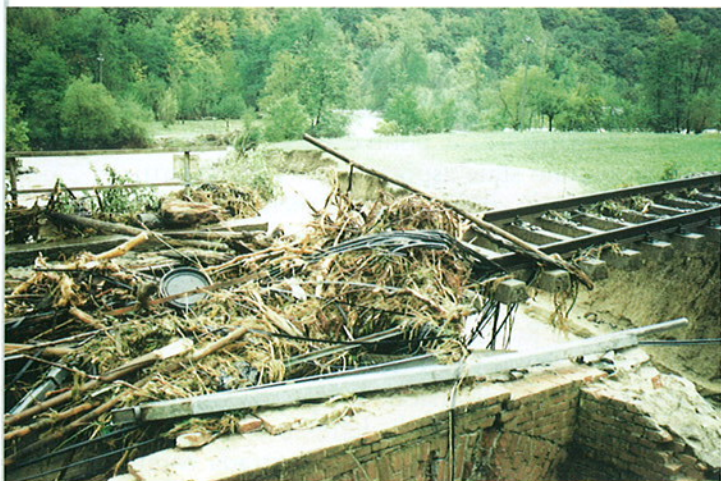
Fig. 8. Comune di Robilante. Particolare della immagine precedente con il rilevato ferroviario asportato per sifonamento.
