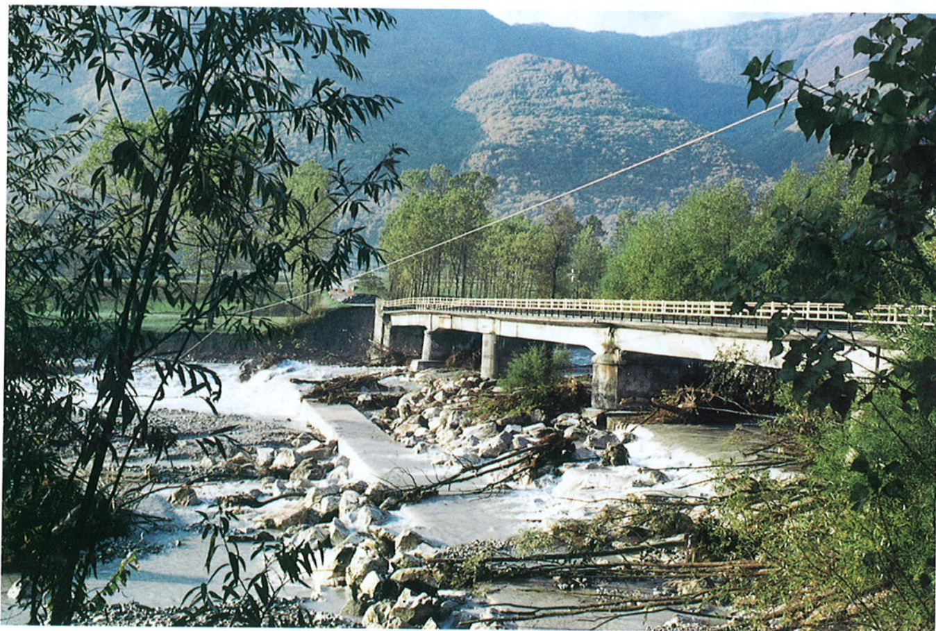
Fig. 2. Fiume Stura di Demonte. Ponte per Festiona in Comune di Demonte (S.P. n. 293). Il ponte, già protetto verso valle da due soglie trasversali, è stato aggirato in sponda destra con cedimento di una pila in alveo e asportazione della spalla e relativo rilevato.
