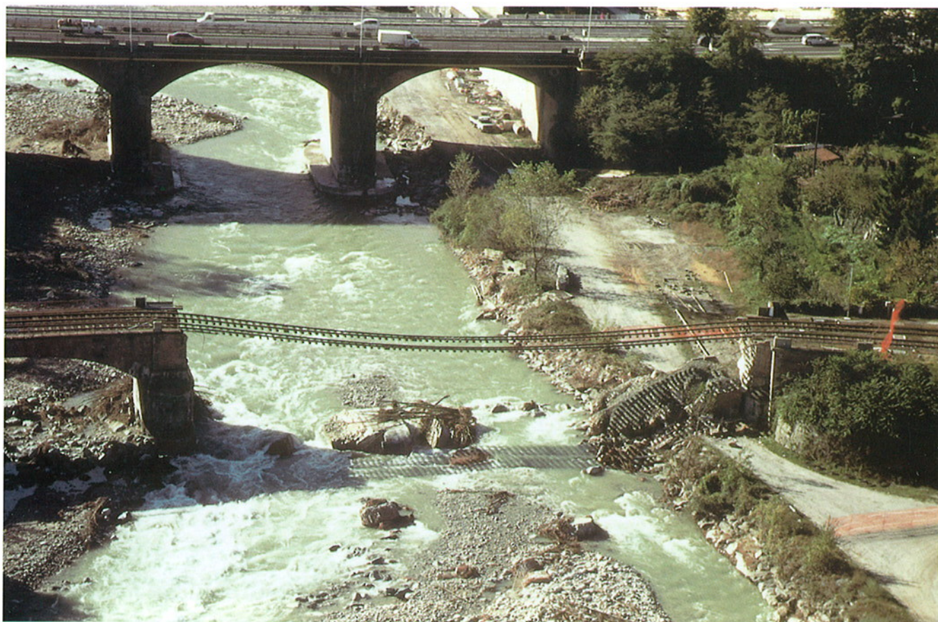
Fig. 6. Cuneo. Ponte ferroviario della linea Cuneo-Mondovì crollato per la piena del torrente Gesso.
