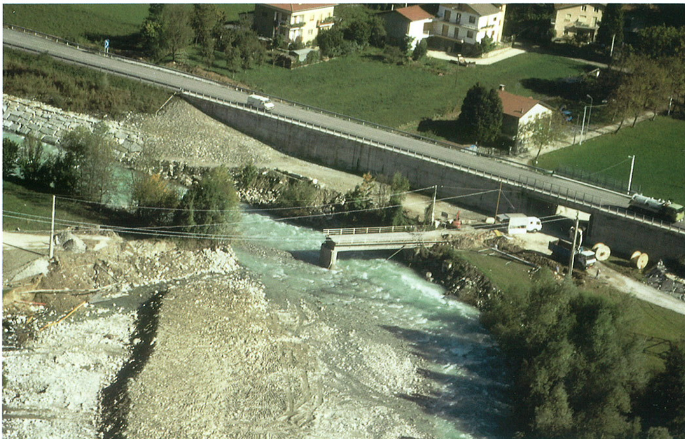
Fig. 9. T. Vermenagna, Robilante concentrico. Ponte per Istituto Climatico crollato a causa della sezione di deflusso insufficiente.
