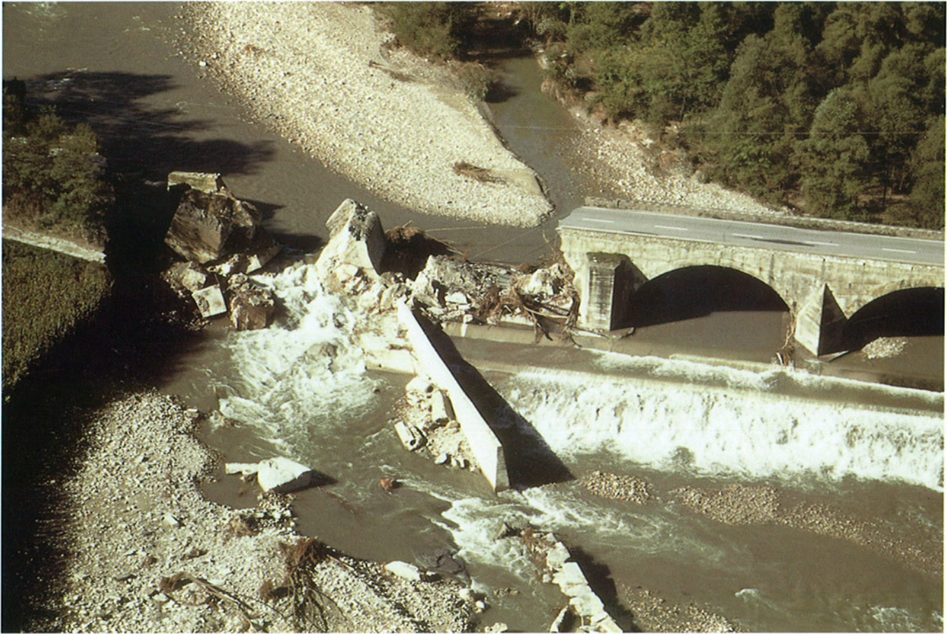
Fig. 13. Distruzione di due arcate del ponte della S.S. n. 28 sul t. Pesio. La prima arcata (destra idrografica) risultava già occlusa da una preesistente strada di servizio alla vicina area di cava, come testimoniato dalla centrale posizione del muro d'argine.
