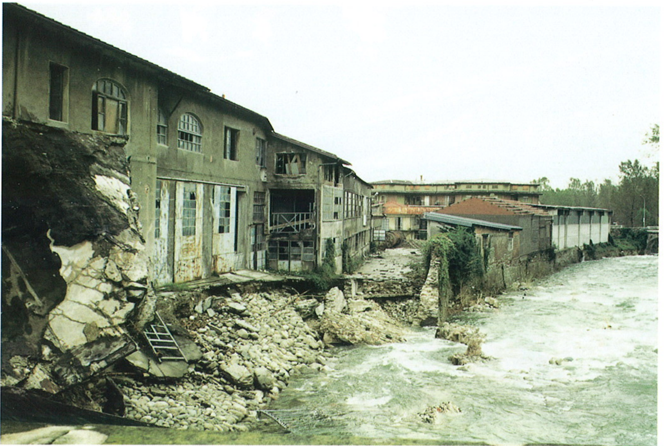
Fig. 11. Chiusa Pesio. Erosione in sponda sinistra del T. Pesio a valle di un ponte del concentrico con grave danneggiamento di un vecchio edificio produttivo costruito in fregio al corso d'acqua.
