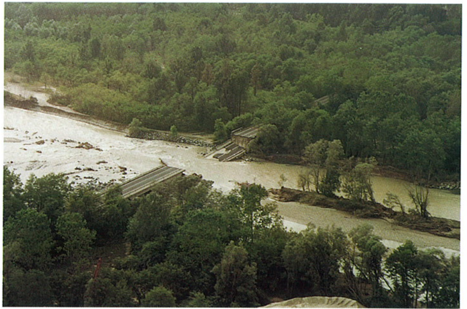
FOTO 51 - Ponte tra San Benigno e Foglizzo (deflusso verso sinistra). Il canale attivo, prima dell'evento era prossimo alla sponda sinistra; in seguito, il canale si è approfondito in corrispondenza della sponda destra per erosione rimontante, successiva allo sfondamento della soglia a valle. L'erosione di fondo ha determinato anche lo scalzamento di una delle pile, con crollo del ponte.
