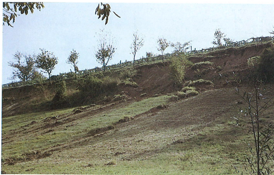
Foto 82 - Roccaverano (AT), smottamenti e ruscellamenti lungo la S.P. 56.
