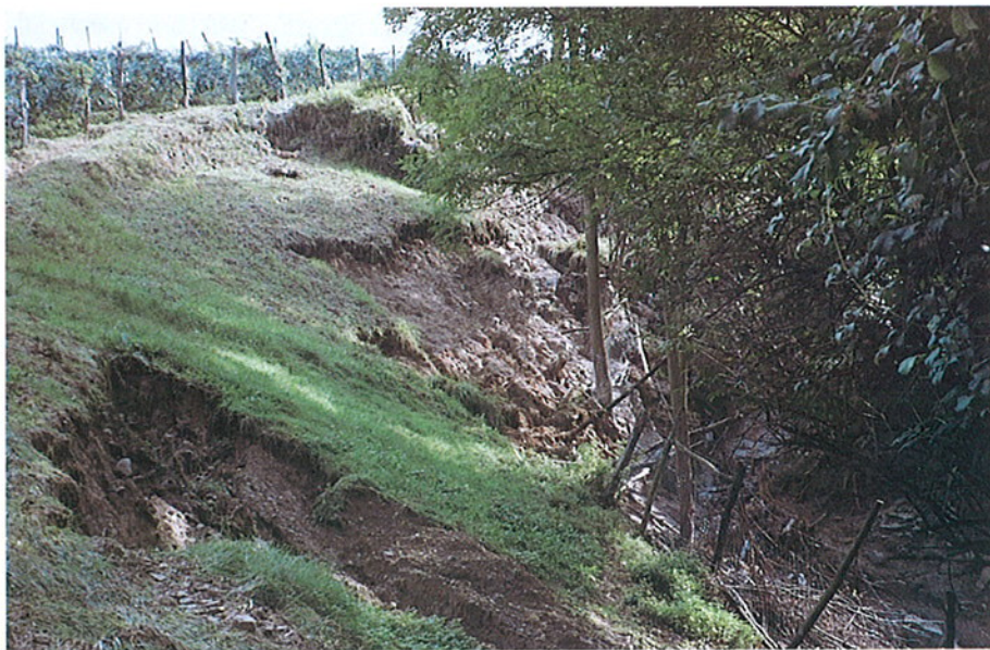
Foto 83 - Roccaverano, smottamenti lungo la S. P. 56.
