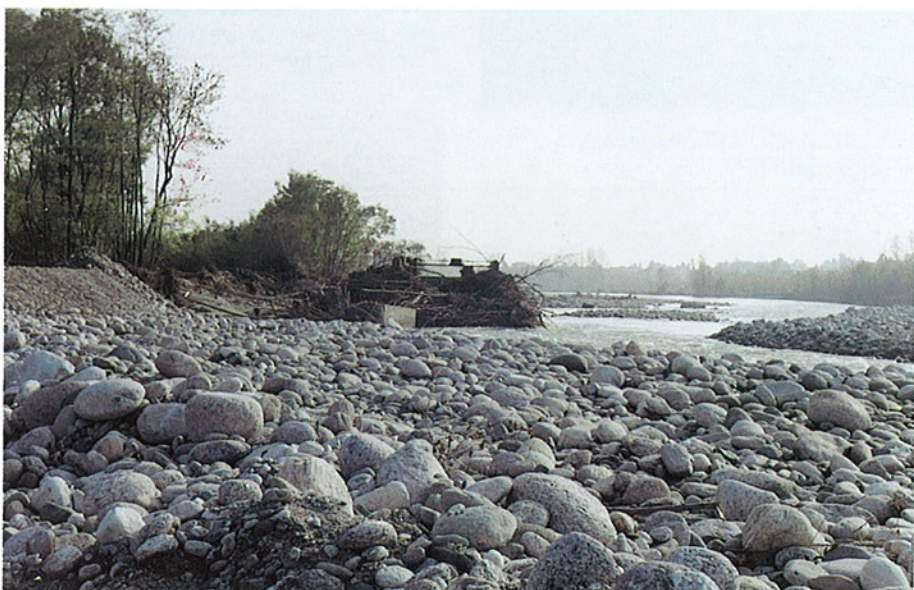
FOTO 49 - Presa del Rio Vercellino: l'opera è stata aggirata dalla corrente ed ora si trova all'interno dell'alveo principale del torrente, modellato dalla piena del settembre 1993.
