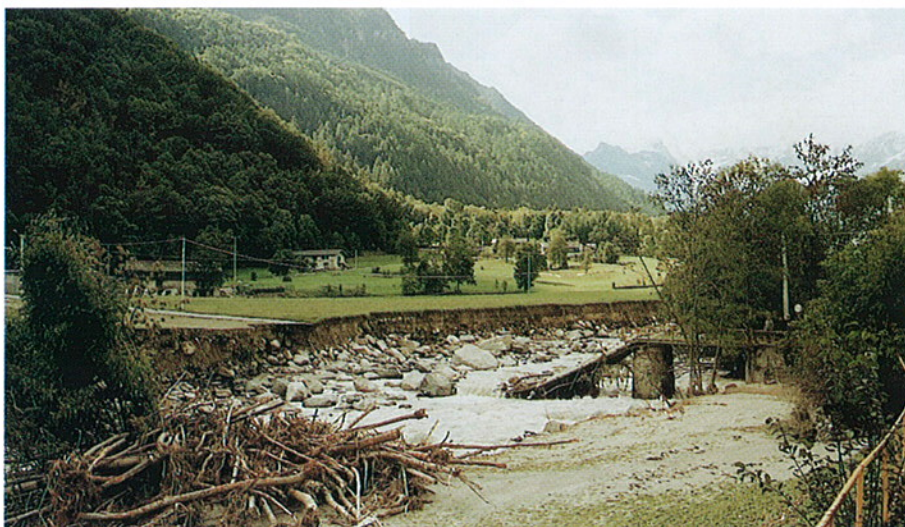
Foto 60 - Comune di Chialamberto: località Cossiglia. Crollo del ponte sul T. Stura causato dall'erosione torrentizia in sponda destra che ha completamente asportato la spalla del ponte.
