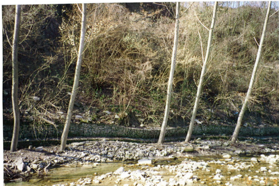
Foto 81 - Comune di Perletto (CN). Gabbionate scalzate al piede con innesco di una frana nella scarpata sulla sinistra del Rio Tatorba in località Cascina Bormiotti.
