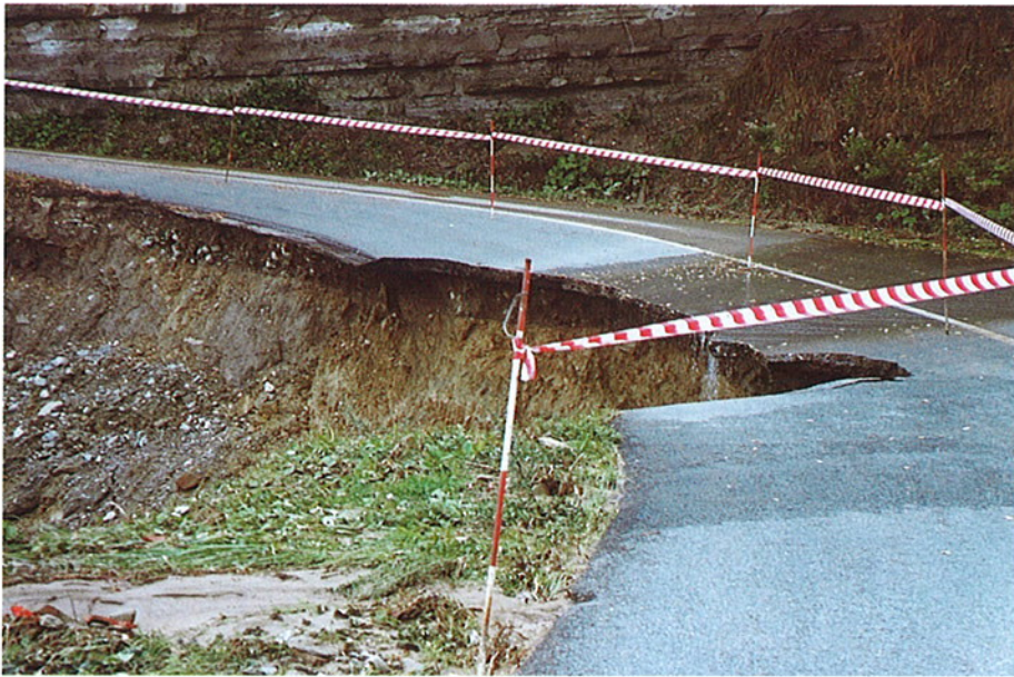
FOTO 85 - Vesime-Olmo Gentile, franamento di un tratto della S.P. 24.
