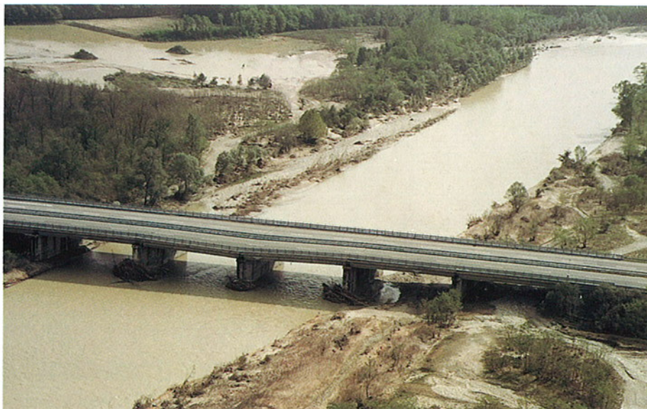
FOTO 53 - Ponte dell'Autostrada Torino-Aosta. La pila centrale si è abbassata, provocando il cedimento del piano viario (deflusso da sinistra verso destra).
