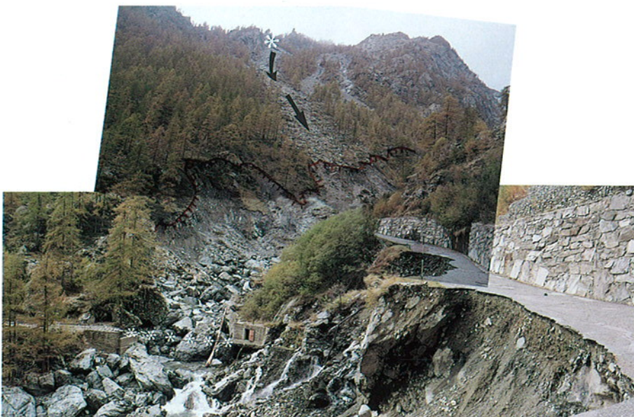
FOTO 40 - Valprato, zona Madonna della Neve a monte della frazione Pianetto. In primo piano un tratto di strada asportato unitamente al ponte (la cui posizione è tracciata con asterischi). In secondo piano l'ampia frana innescata dall'erosione in isponda destra, al piede di un'ampia deformazione gravitativa profonda. Le frecce nere indicano un canale soggetto a fenomeni di crollo.
