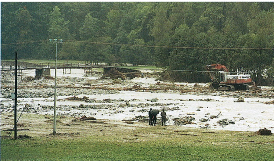
Foto 62 - Comune di Cantoira (TO): località Piagni. Ponte sul T. Stura danneggiato nel corso dell'evento alluvionale del settembre 1993. I rilevati di accesso al ponte sono stati aggirati ed asportati a causa della ridotta sezione di deflusso ostruita dal legname trasportato dalla piena.
