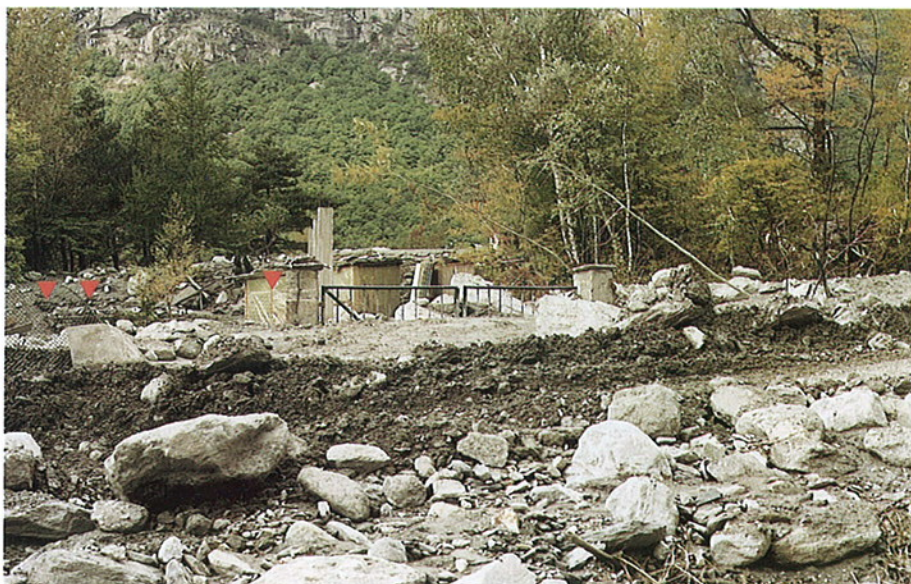
FOTO 74 - Particolare del materiale depositato, poco a valle del ponte sulla provinciale Novalesa-Venaus; da osservare il cancello completamente sommerso dai sedimenti, ma non lesionato ed, in primo piano, verso sinistra (evidenziata), la rete metallica piegata ma non divelta, a testimonianza di lente velocità di propagazione della colata (deflusso verso sinistra).
