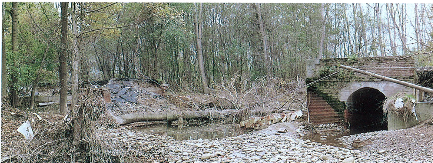
FOTO 56 - Particolare del rilevato della provinciale San Benigno-Fogizzo, sfondato in prossimità di un sottopasso idraulico.
