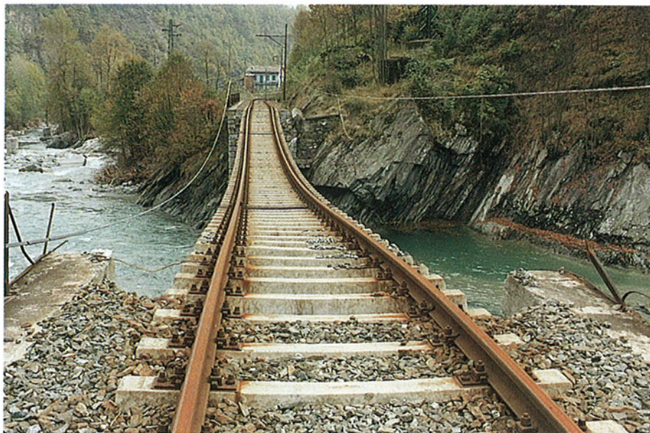
FOTO 65 - Comune di Pessinetto: località capoluogo. Ponte ferroviario sul T. Stura crollato nel corso della piena.
