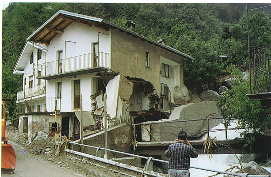
FORO 45 - Noasca (TO), abitazione danneggiata per attivazione del conoide alluvionale del Rio Noaschetta. Lo stesso fenomeno ha provocato, nel settembre 1994 la completa distruzione dell'abitazione.
