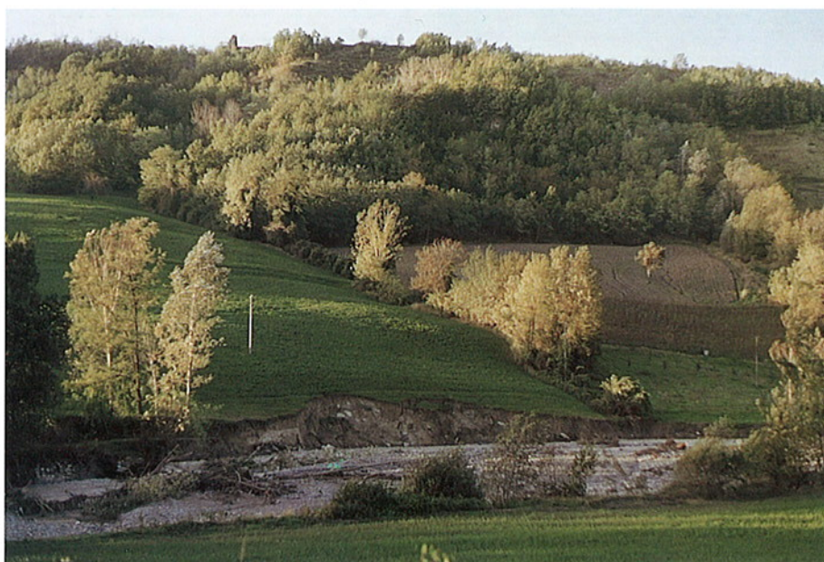
FOTO 88 - S. Sebastiano Curone (AL). Erosione spondale con asportazione di un tratto della sede stradale.
