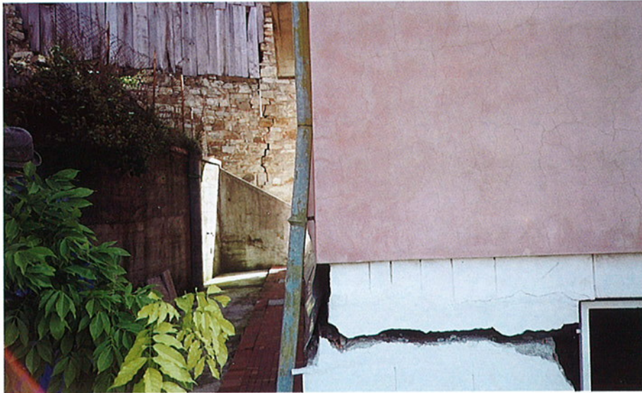
FOTO 93 - Esempio di lesioni strutturali sugli edifici della frazione Montaldo di Cosola.
