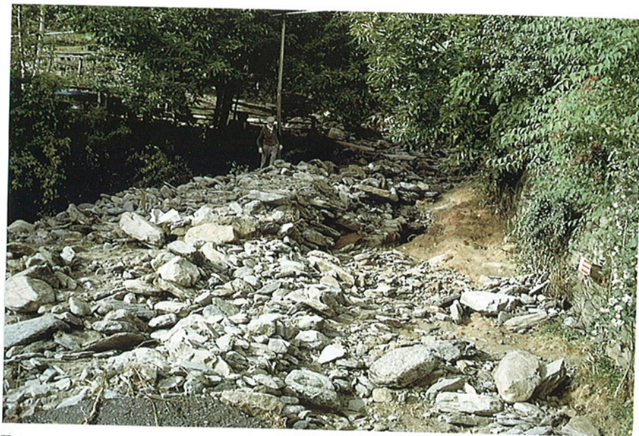
Foto 79 - Comune di Envie (CN). Rio Comba Grande: alluvionamento delle aree adiacenti l'alveo ordinario del rio (canalizzato al centro della foto). Asportazione di un tratto di strada e relativo ponticello.
