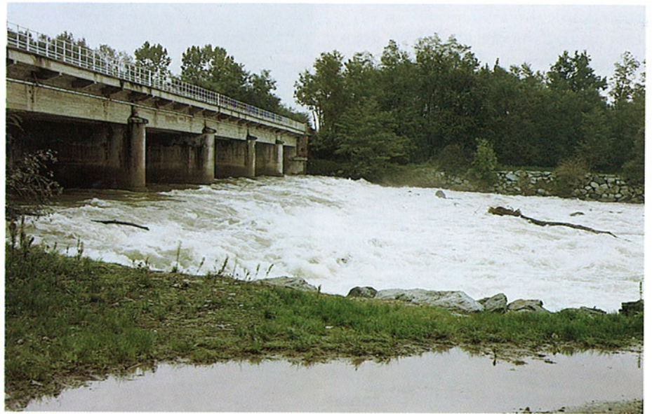
FOTO 52 - Foto scattata dopo la piena del 5/10/1992: la presenza della soglia a valle del ponte già allora aveva favorito l'innalzamento delle acque con conseguenti fenomeni di allagamento a monte e di innesco di fenomeni erosivi di fondo e lungo le sponde a valle.
