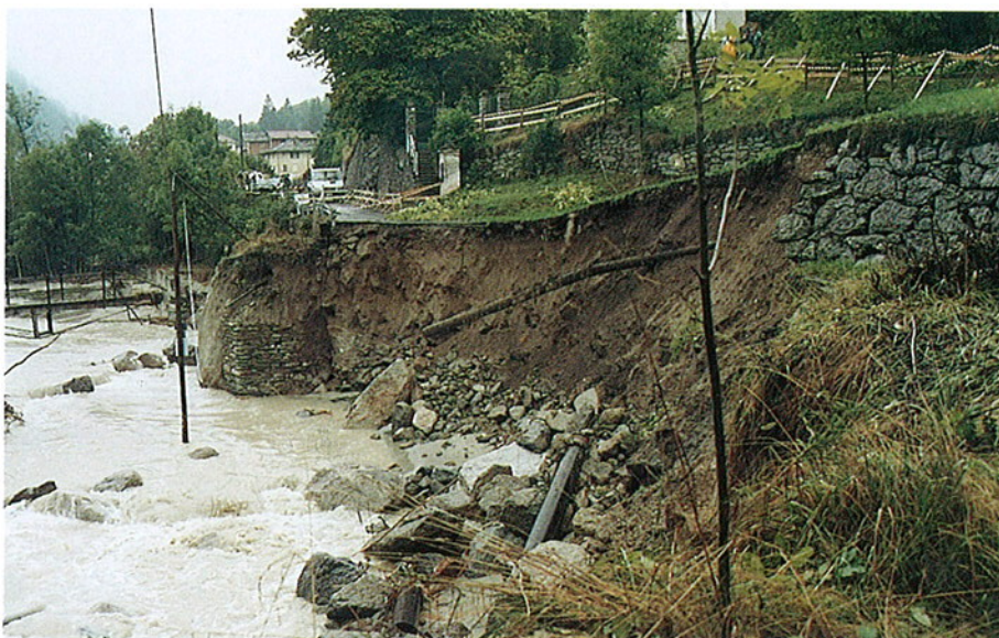
FOTO 59 - Comune di Chialamberto: località Mottera. Frana per erosione al piede del rilevato della Strada Provinciale. L'interruzione della strada ha isolato la parte alta della Valgrande per alcuni giorni.
