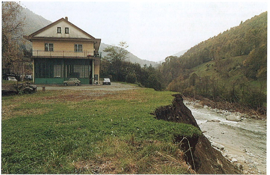
FOTO 63 - Comune di Ceres (TO). Edificio di civile abitazione prossimo al ciglio di una scarpata di erosione del T. Stura.
