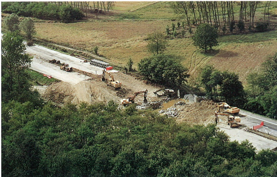
Foto 57 - Autostrada Torino-Aosta: interruzione dovuta allo sfondamento di un sottopasso idraulico.
