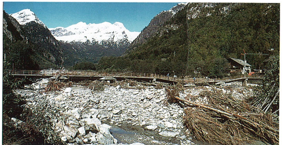
FOTO 13 - Vista da valle del ponte per Gabbio che ha sopportato l'impeto della piena funzionando da sbarramento in destra e consentendo il maggior deflusso delle acque in sinistra, che hanno causato l'abbassamento di una pila per erosione delle fondazioni.
