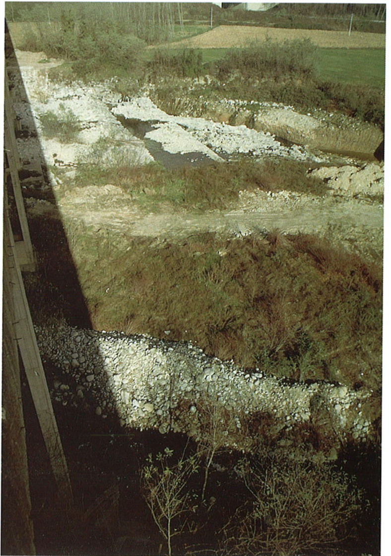
FOTO 15 - Vista dell'alveo del Torrente Cervo a valle del ponte-viadotto sulla S.S. 142 l'anno precedente la piena. La fotografia mostra con chiara evidenza i forti processi erosivi in atto che si arrestano ai piedi della soglia di stabilizzazione a difesa del ponte-viadotto. Il dislivello tra l'alveo poco a monte della soglia e quello visibile a valle misura in questo periodo circa 10 metri. In primo piano in basso il canale in erosione attivo in corrispondenza delle pile che poi verranno abbattute nel corso della piena del 1993.
