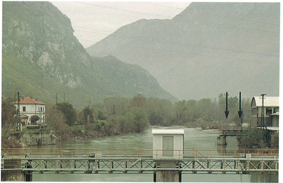
FOTO 17 - Quincinetto (TO): in secondo piano si osserva (indicata dalle frecce) la struttura restante del ponte crollato durante la piena.
