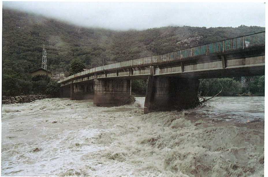
FOTO 18 - Ponte di Quassolo (TO): pila scalzata per accentuata erosione di fondo.
