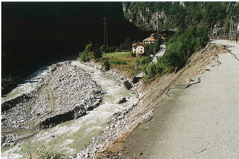
FOTO 1 - Trasquera (VB), località stazione di Iselle. L'erosione laterale del T. Diveria ha asportato le opere di difesa idraulica (di cui si intravedono i resti verso il margine inferiore sinistro della foto) ed il corpo stradale della S.S. 33, intaccando il rilevato ferroviario e la strada di accesso alla stazione (in primo piano).
