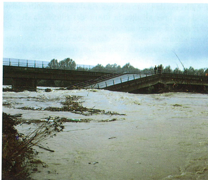
Fig. 12. Ponte lungo l'autostrada Torino-Milano per l'attraversamento del Torrente Orco. La fotografia mostra un tratto del corso d'acqua durante l'evento di piena dell'8 ottobre 1977 che ha provocato la demolizione della corsia verso Torino.
