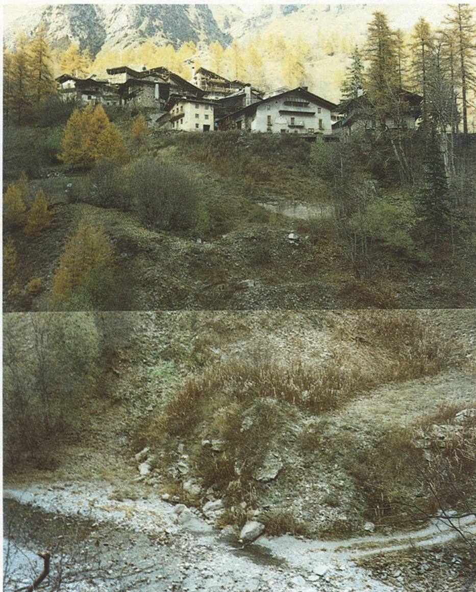
Fig. 4 - Nella fotografia sono mostrati i rapporti esistenti tra l'alveo del torrente (qui in corrispondenza della maggiore delle due briglie di contenimento) e l'abitato posto 60 m a monte sul piede dell'accumulo di frana. Sotto l'abitato è visibile parte del muro di sostegno coinvolto, in epoca recente, nei movimenti più epidermici.
