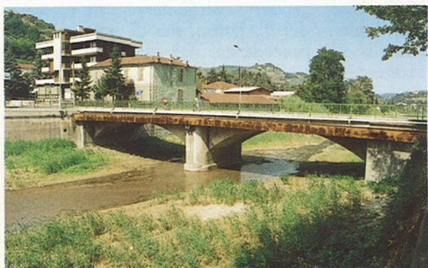
Fig. 2 - Ponte sul T. Belbo nel centro dell'abitato. L'opera di attraversamento ha una luce di circa 120 m 2 che potrebbe rivelarsi tuttora insufficiente se si ripetessero gli eventi di piena registrati nel 1948, 1951 e 1968.
