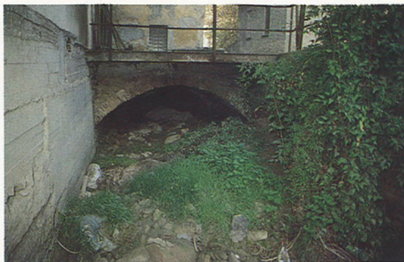
Fig. 3 - Luce del Rio Acquafredda all'inizio del canale sotterraneo che attraversa l'abitato, come appariva nel maggio 1990. Sarebbe sufficiente un'ordinaria ed accurata pulizia dell'alveo per evitare disastrosi disalveamenti (1948, 1951 e 1968) durante notevoli eventi pluviometrici.
