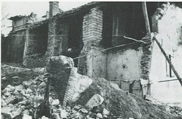
Fig. 7 - Un'abitazione di Brusaschetto ritratta nel 1955. Gli sprofondamenti delle sottostanti gallerie minerarie causarono periodici cedimenti differenziali del piano di posa e il conseguente crollo della struttura.
