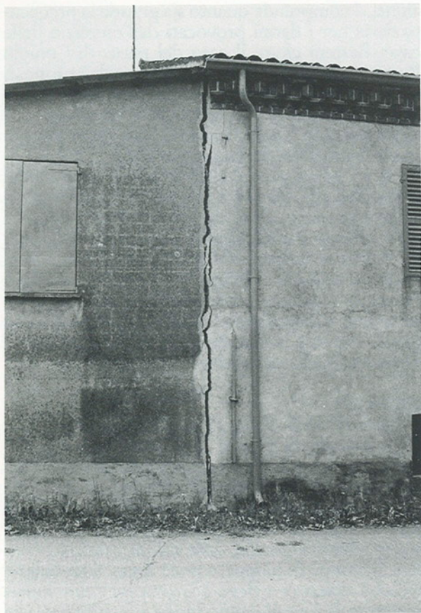
Fig. 3 - Fabbricato attualmente lesionato nel quale si rileva una profonda fenditura nel muro perimetrale, evidenziatasi verso l'inizio degli anni '80.
