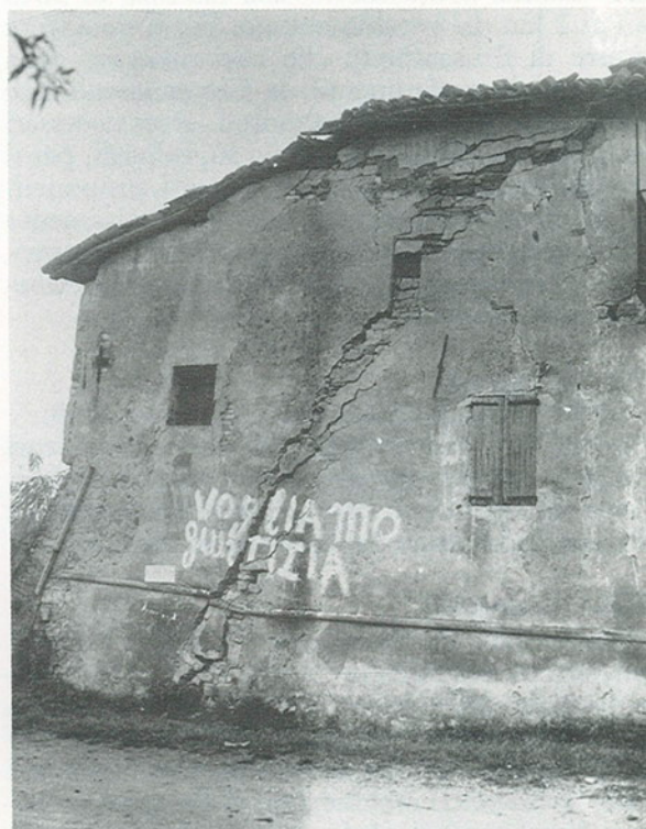
Fig. 6 - C.na Ricci, come appariva nei primi anni '50, lesionata da profonde crepe nei muri perimetrali.
