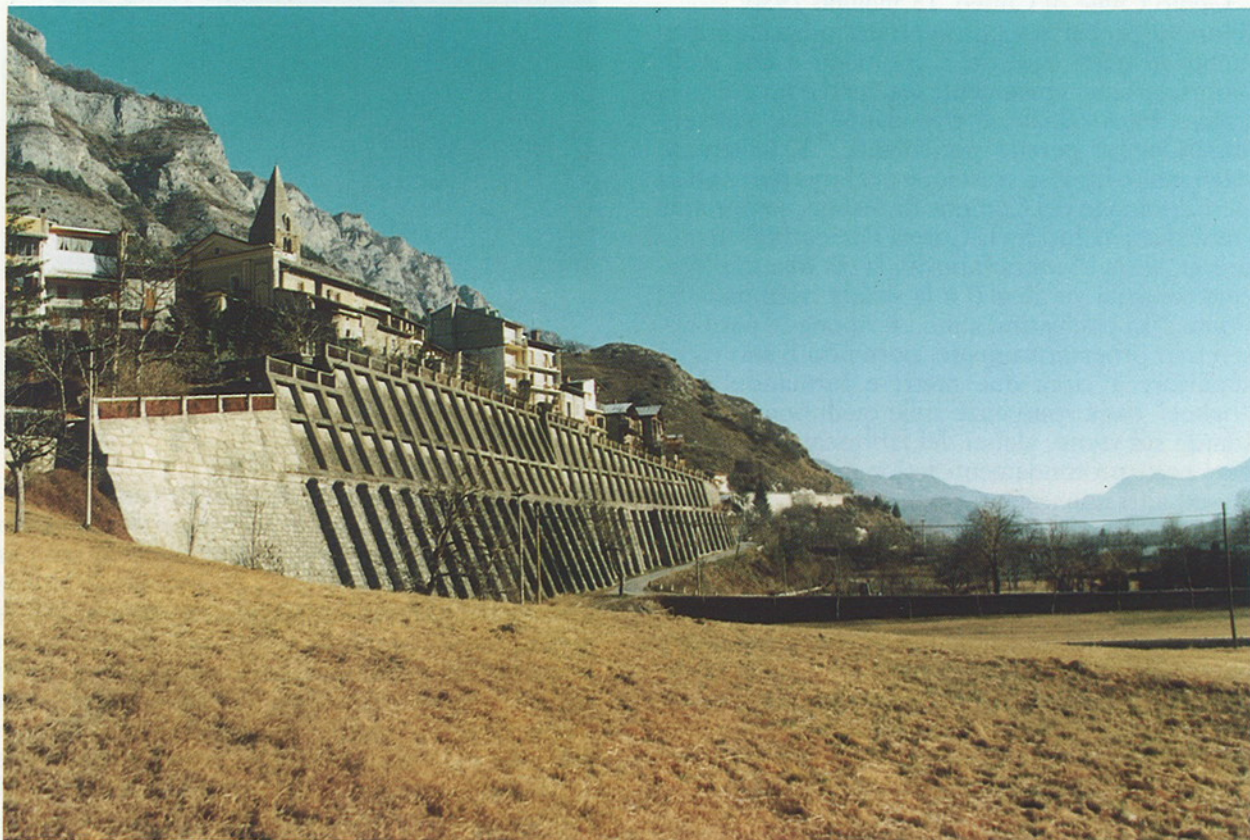
Fig. 5 - Veduta dell'intervento di consolidamento della scarpata sottostante il nucleo storico del centro abitato. Il muro a speroni fu costruito tra il 1891 e il 1957, in lotti successivi, per sostenere il ciglio della scarpata e impedirne l'ulteriore degrado.
