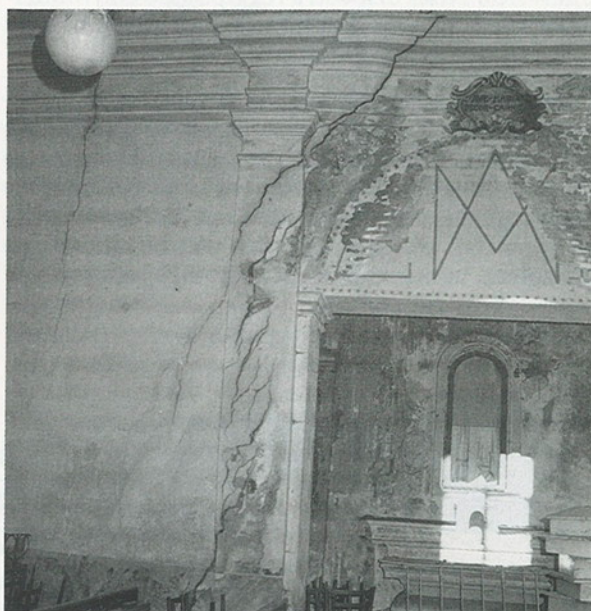
Fig. 4 - Nei muri perimetrali della chiesa, attualmente abbandonata, si rilevano numerose crepe che, in alcuni casi, attraversano totalmente lo spessore del muro.
