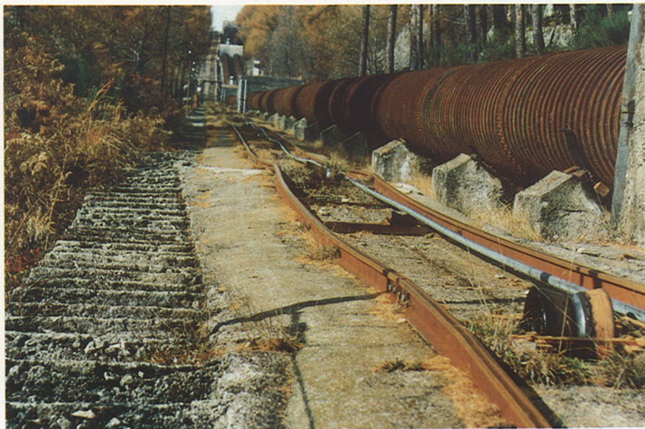
Fig. 3 - Impianto idroelettrico dell'A.E.M. di Torino. La foto mostra lo stato di deformazione del piano di risalita delle condotte. Visibili anche i cunei di legno utilizzati per correggere gli spostamenti differenziali venutisi a creare tra condotte e selle di supporto in seguito ai movimenti del terreno.
