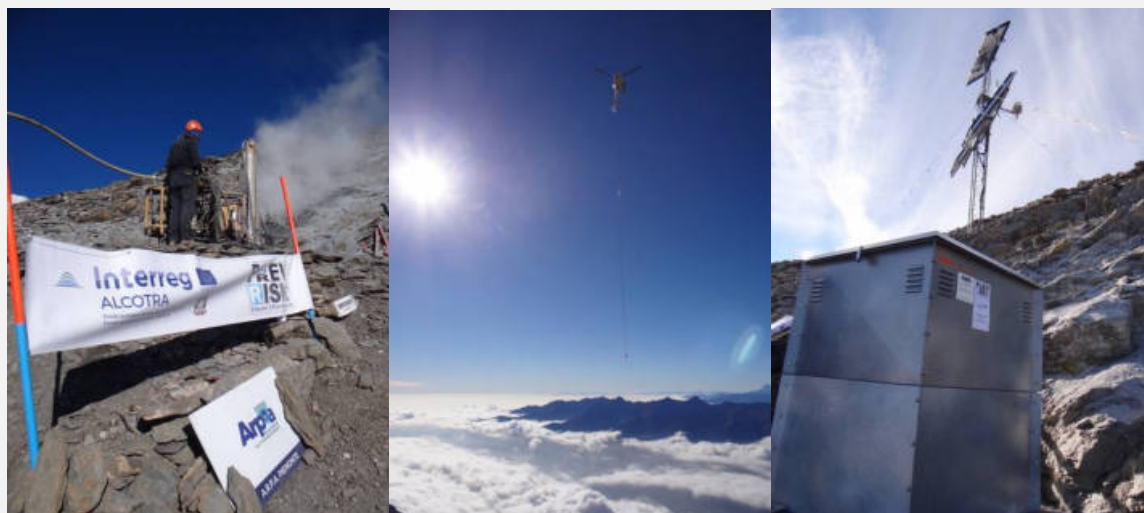
Figura 9 – Installazione della colonna multiparametrica DMS sul M. Rocciamelone (Piemonte, Italia). A sinistra: perforazione di 30 m di profondità a distruzione di nucleo utilizzando l'aria compressa. Al centro: inserimento della colonna DMS con elicottero. A destra: scatola metallica che ospita i dispositivi di superficie. Il traliccio supporta il sistema di alimentazione fotovoltaica e le antenne di trasmissione dati.
