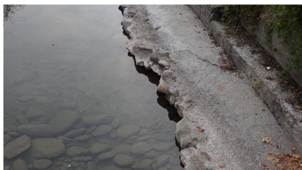
Dettaglio platea con lieve sottoescavazione..
