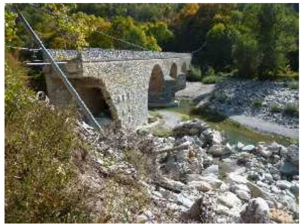
Ponte danneggiato in occasione dell'evento alluvionale di novembre 2016.
