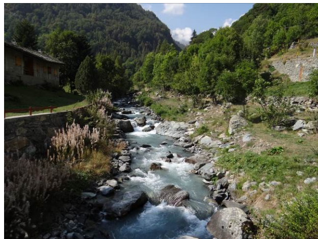
Difesa in corrispondenza del ponte tra Fraz. Cornetti e Villaggio Albaron.
