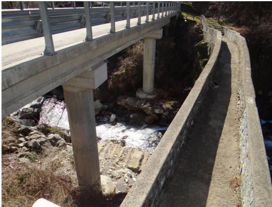
Ponte e passerella per Fornero. Il ponte presenta la soglia a protezione delle pile quasi completamente erosa
