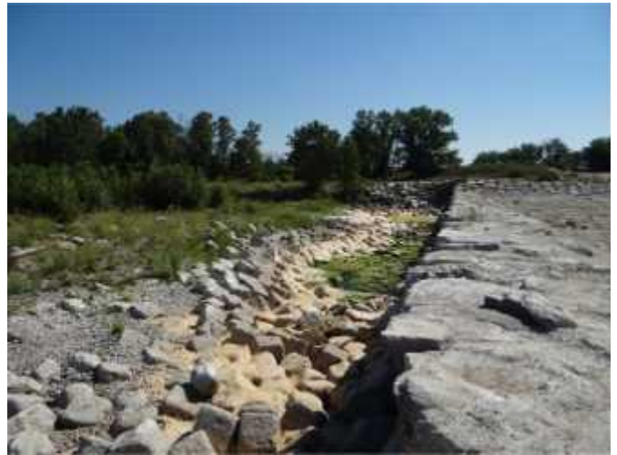
Erosione alla base della soglia.
