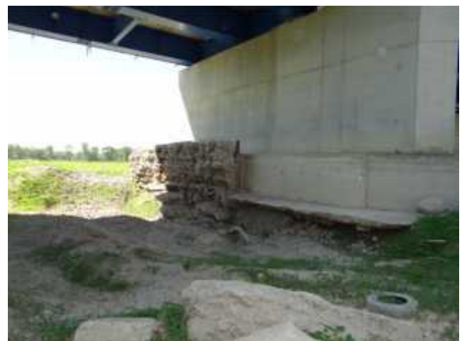
Particolare di una pila sottoescavata.
