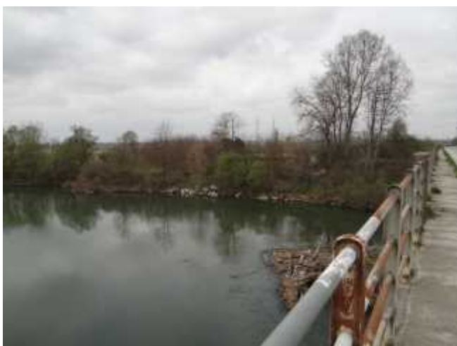
Materiale flottante intrappolato dalle pile del ponte della SS 20.
